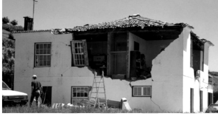
Şekil 1.1 1998 Azores depremi sonrası oluşan düzlemdışı hasar (Costa, 2012)
