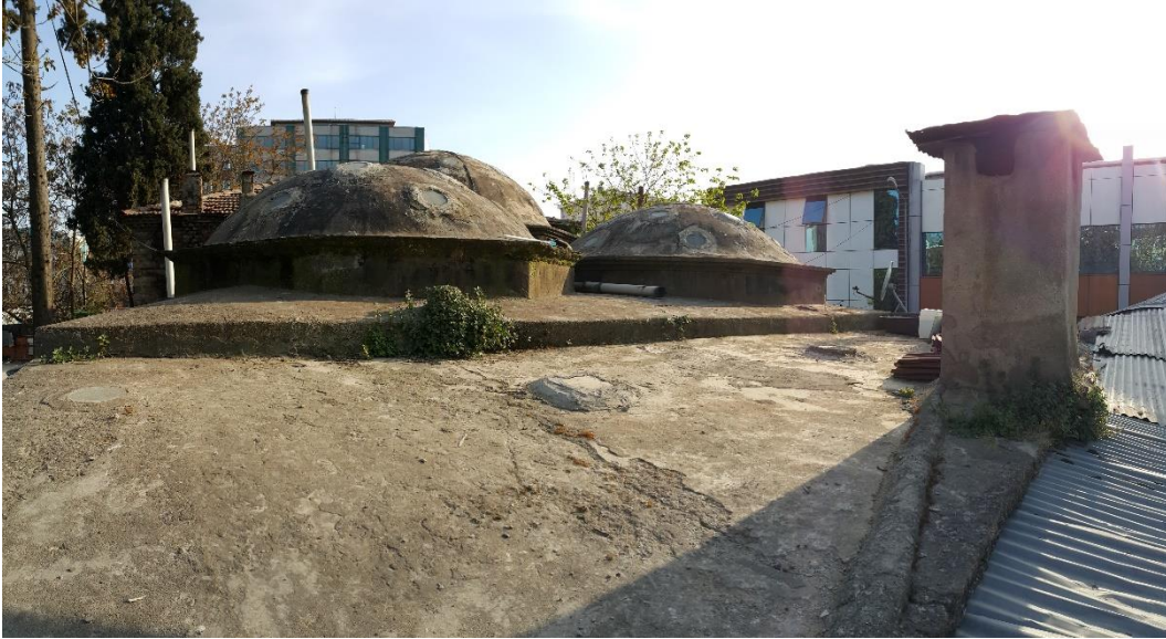
Şekil A.134 : Su deposu beton çatı örtüsü.
