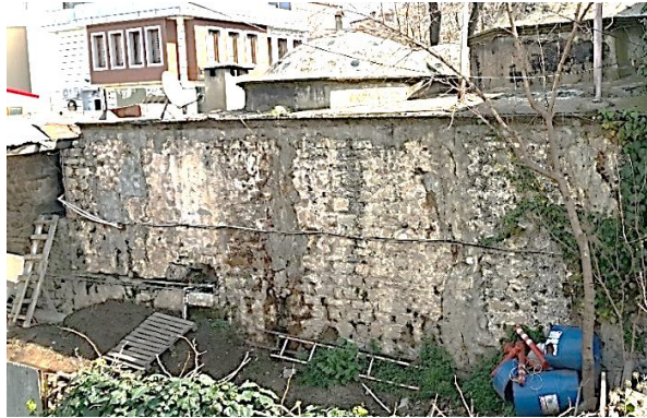
Şekil 3.19 : Batı cephesinde görülen bozulmalar.
