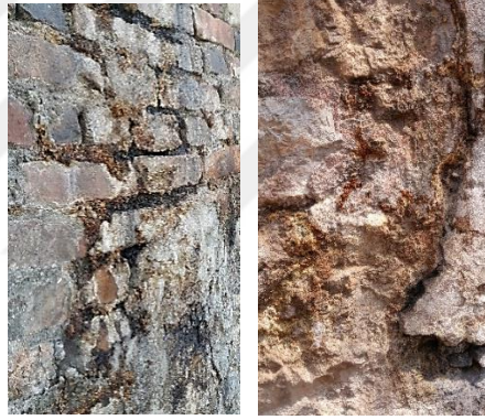
Şekil 3.18 : Soyunmalık kuzey duvarı ve batı cephesi duvarında görülen mantarlar.
