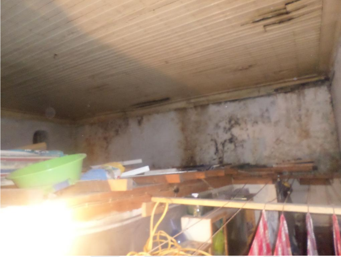
Şekil A.43 : Soyunmalık bölümü kuzey duvarında nem problemi.
