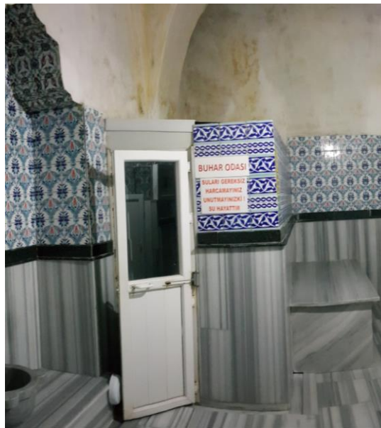
Şekil A.116 : Sıcaklık mekânındaki buhar odası.
