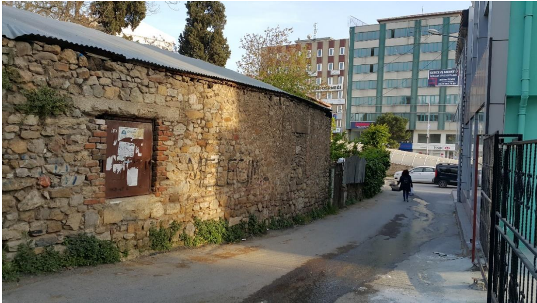
Şekil A.161 : Batı Cephesi Müstemilat Duvarı.
