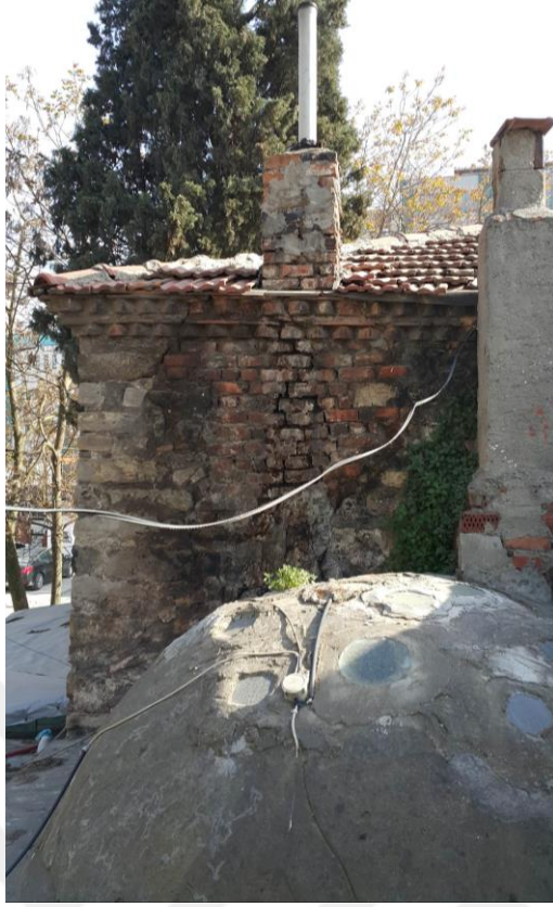
Şekil A.182 : Kuzey cephe hasarlı duvar.
