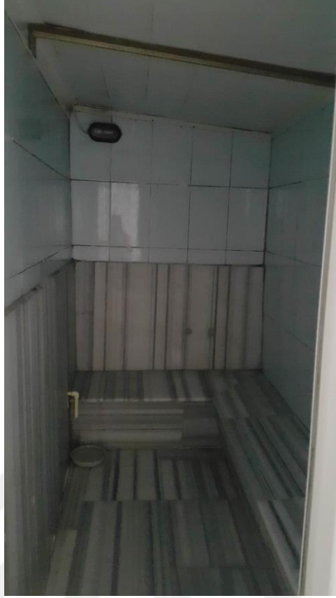
Şekil A.117 : Sıcaklık mekânındaki buhar odası.
