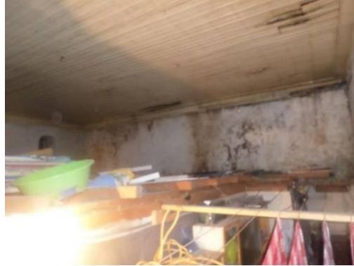
Şekil 3.14 : Soyunmalık mekânı kuzey duvarında görülen bozulma.
