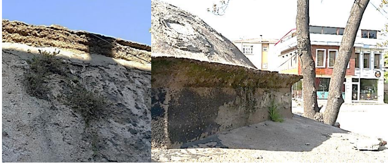
Şekil 3.15 : Saçak kornişlerinde görülen profil kayıpları.
