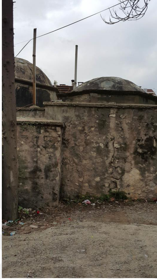
Şekil A.177 : Doğu cephesi duvarında görülen bozulmalar.
