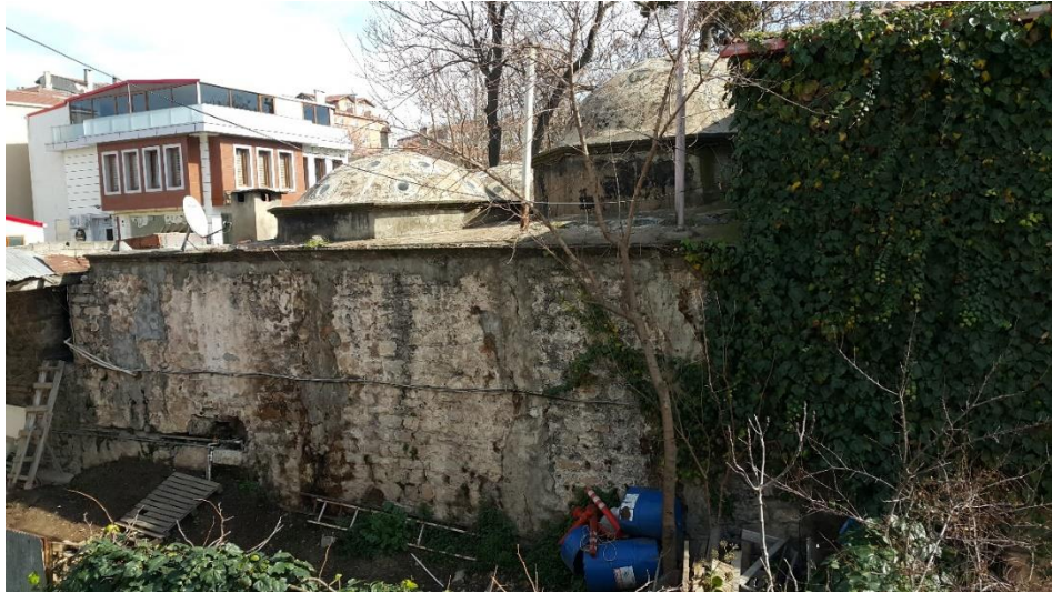
Şekil A.158 : Batı cephesine ait hasarlı duvar.
