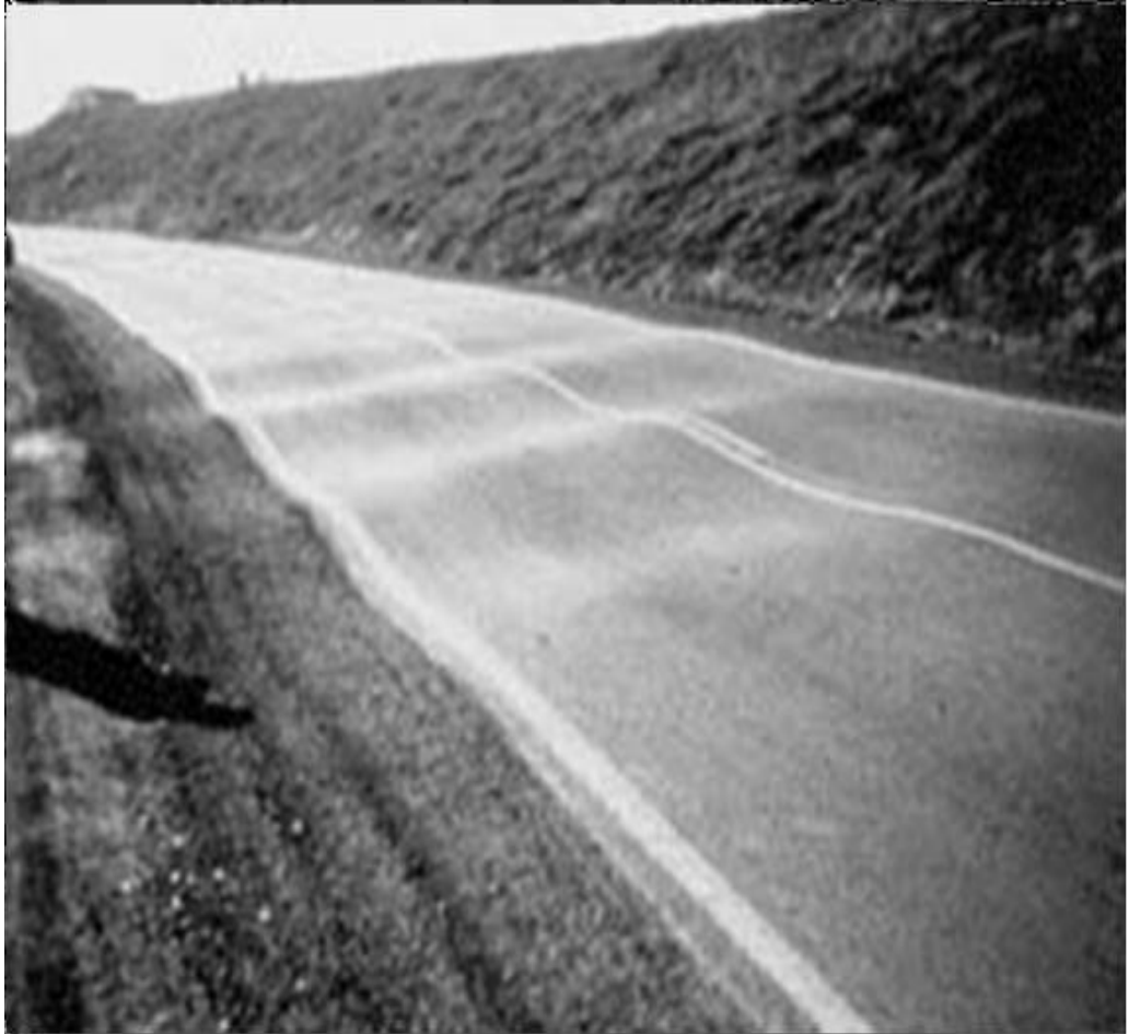
Şekil 2.14 : Esnek üstyapılarda Ondülasyon Türü Yol Bozulması [16].
