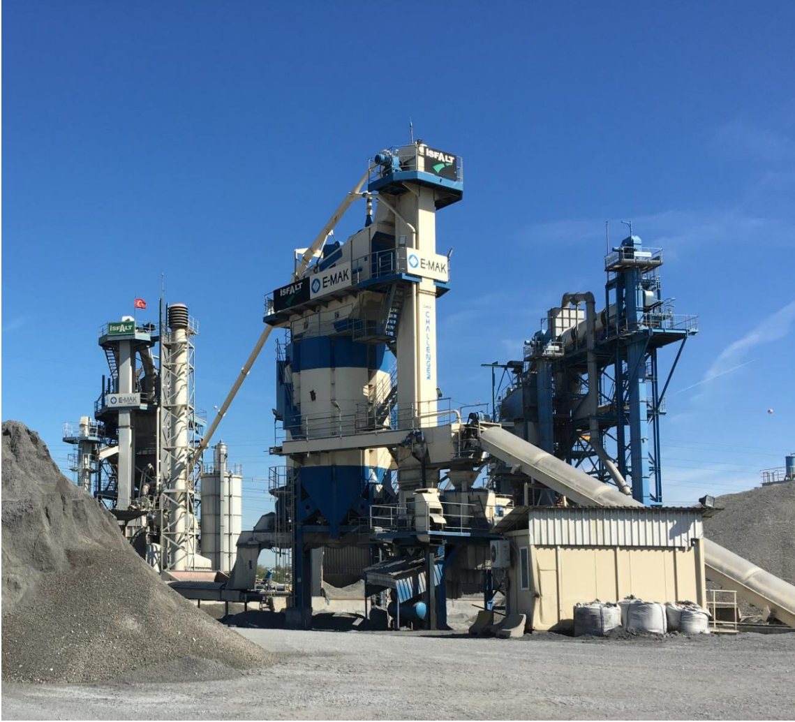
Şekil 2.8 : Batch-mix tipi asfalt plantleri (İsfalt Habibler Fabrikası).
