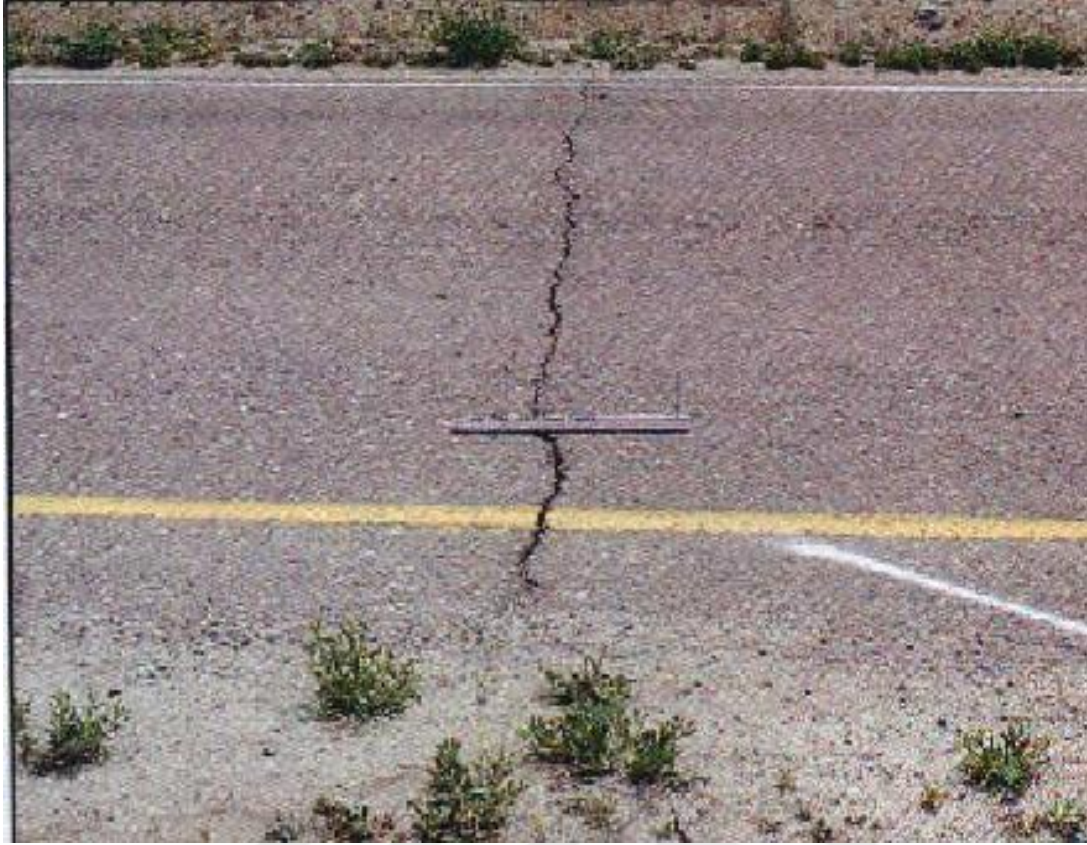
Şekil 2.17 : Esnek Üstyapı kaplamalarında enine çatlaklar [31].
