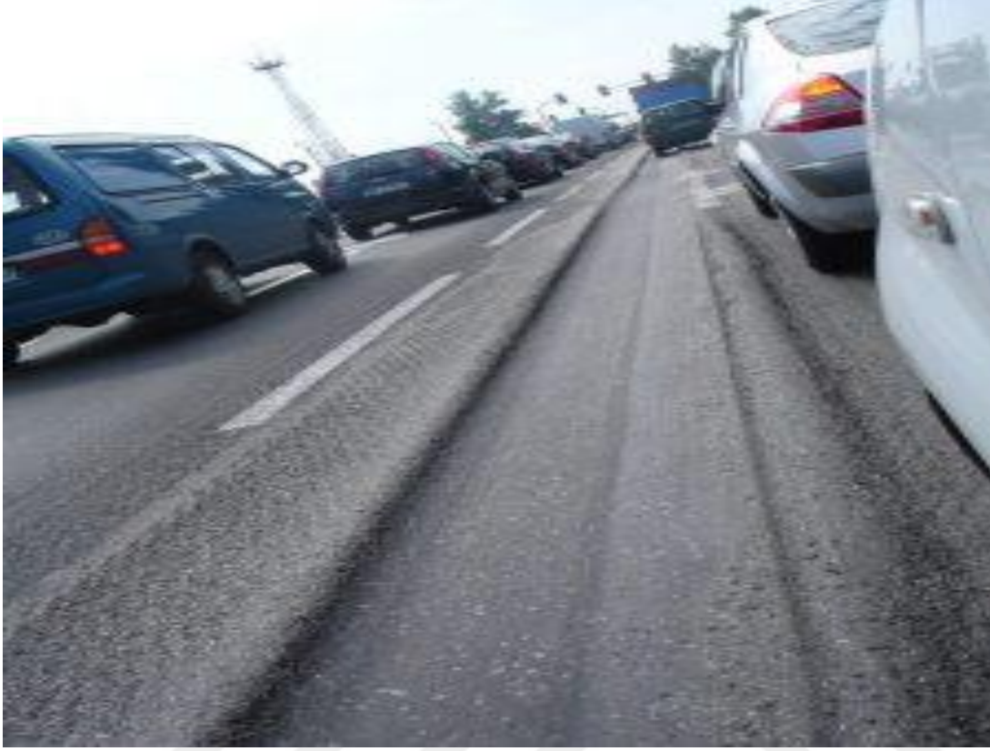
Şekil 2.13 : Esnek üstyapılarda tekerlek izi türü yol bozulması [25].
