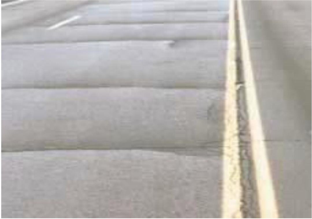
Şekil 2.20 : Esnek Üstyapılarda yansıma çatlağı görünümü [30].
