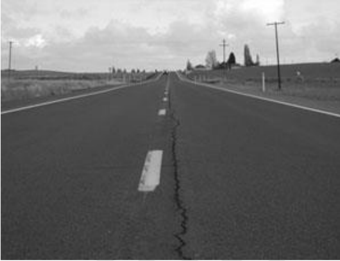
Şekil 2.19 : Esnek üstyapılarda boyuna çatlak şeklinde yol bozukluğu [32].
