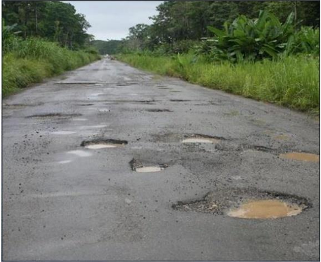
Şekil 2.16 : Esnek üstyapılarda çökme şeklinde yol bozulması [13].
