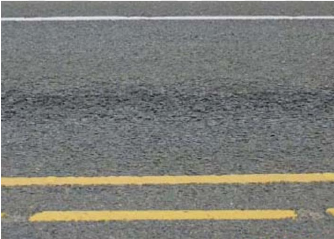
Şekil 2.21 : Esnek üstyapılarda sökülme şeklinde yol bozulması [30].
