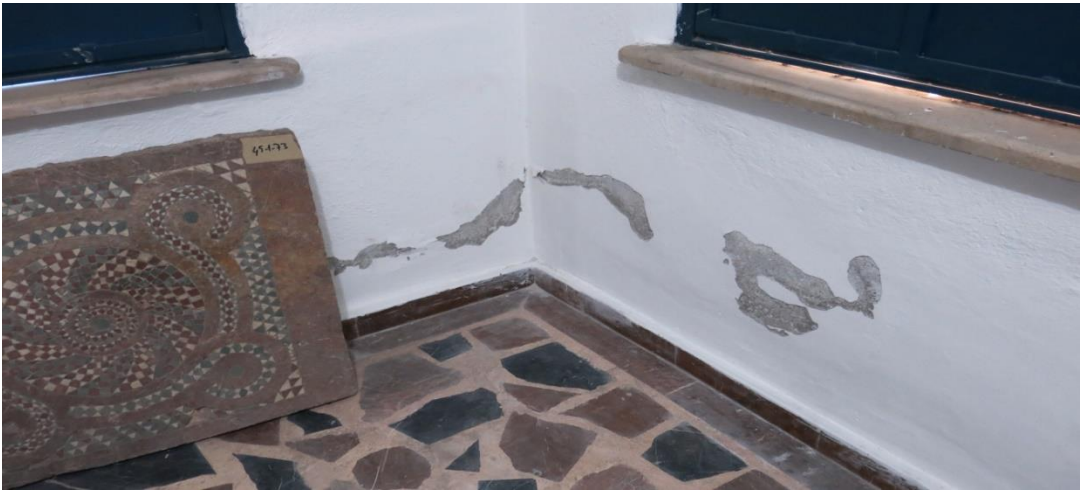
Resim 5.53. Zeminden yükselen nemle ilişkili sıva dökülmeleri
