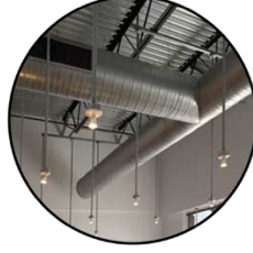
açıktaki bırakılmış tesisat
