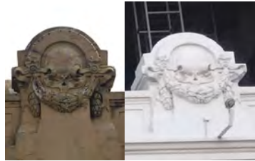
Şekil 4.17: Cephe Süsleme Elemanı Eski ve Yeni Karşılaştırması
