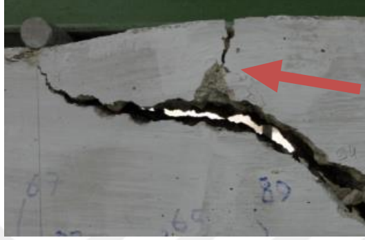
Şekil 4.26. Yük ile Mesnet Arasında Meydana Gelen Diğer Çatlak
