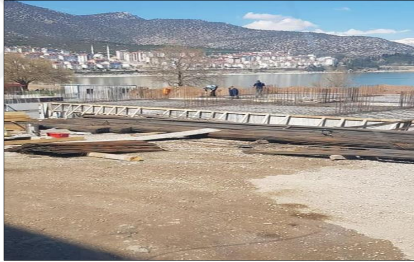
Foto 9. Göl Koruma Sınırı İçerisine Yapılan İnşaat Çalışmaları (Eğirdir İlçesi Merkezi, Menderes Mahallesi)
