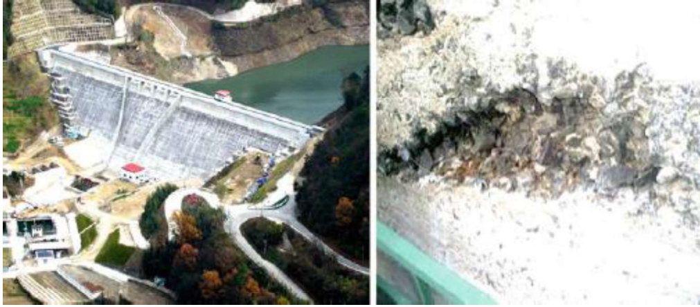
Şekil 2.8 Mitaka Barajı ve su aşınmasından kaynaklı hasarı (Li, 2019).
