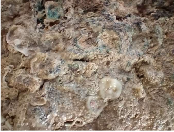
Şekil 37: Mikrobiyolojik Korozyon Oluşumu
