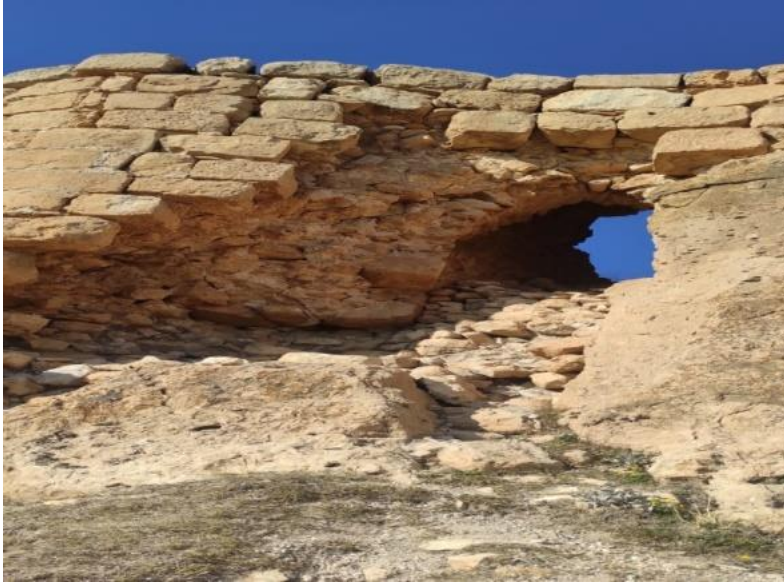
Görsel 2. Yıkılmış Savur Kalesi Duvarı (Kişisel Arşiv, 2022)
