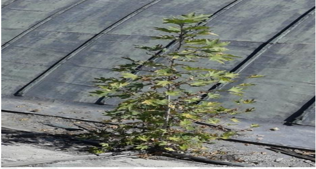
Fotoğraf 139: Rüstem Paşa Kervansarayı Çatısında Bitki Oluşumu
