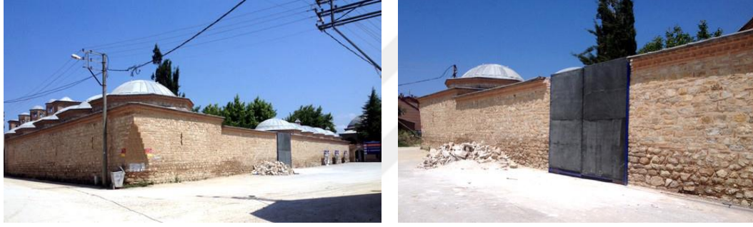
Fotoğraf 38 – 39: Sinan Paşa Külliyesinin Yıkılan Duvar Dıştan Görünüşü ve Yıkılan Duvar Dış Detay Görünüş (Bıçak, 2015)
