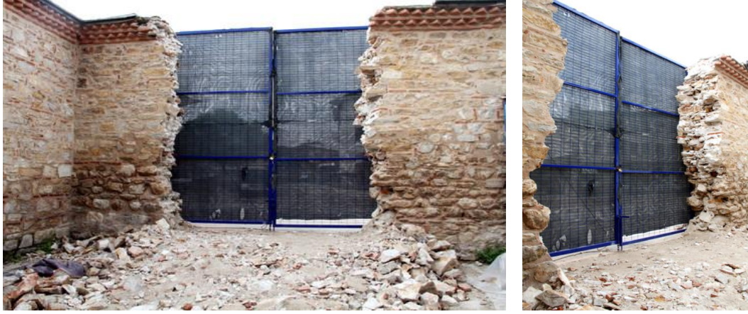
Fotoğraf 36 – 37: Sinan Paşa Külliyesinin Yıkılan Duvar Kapı Görünüşü ve Yıkılan Duvar İç Detay Görünüş (Bıçak, 2015)
