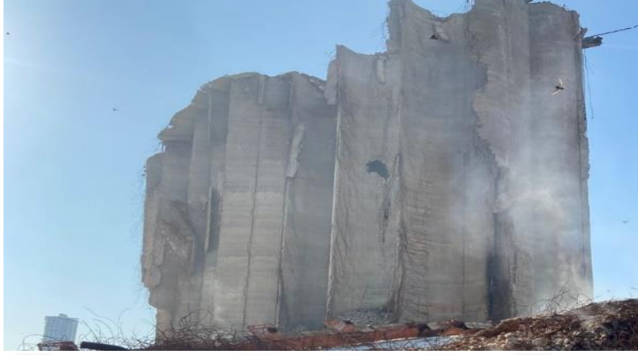
Şekil 3. 17. Hasarlı kısım. (Kaynak: yazar)
