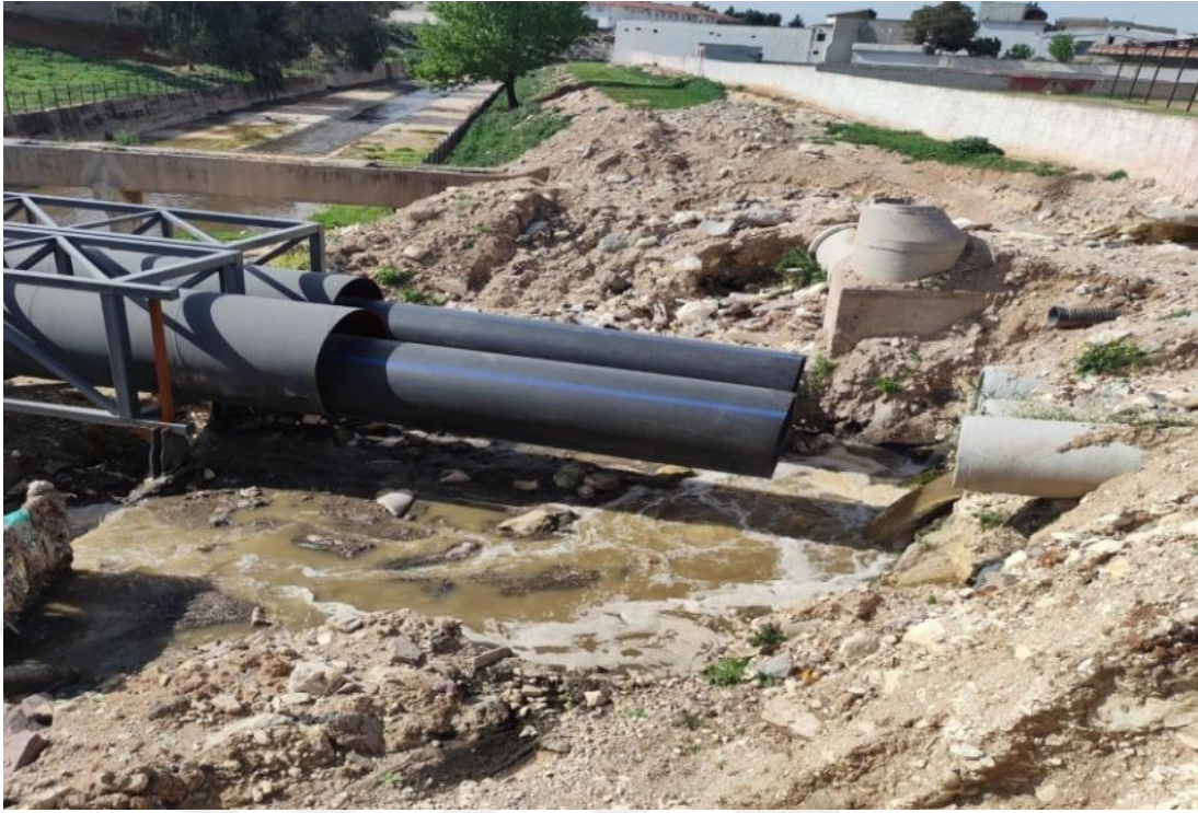
Şekil 5.20. Kanalizasyon Sularının Nizip Çayına Bırakıldığı Alan
