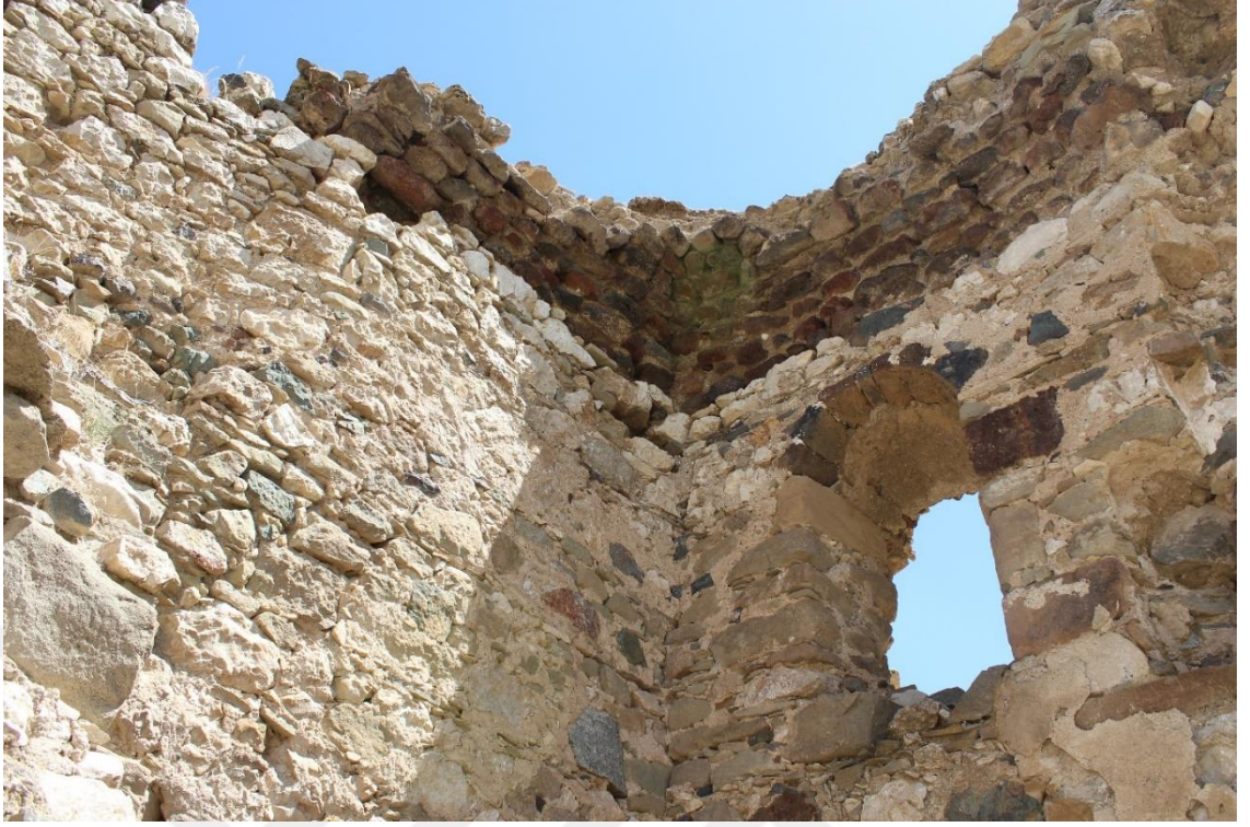
Foto. 47: Merkez ilçesi Gürcü Bey Mahallesi Surp Garabed (Kızıl) Manastır Kilisesi üst örtü kalıntı detayı
