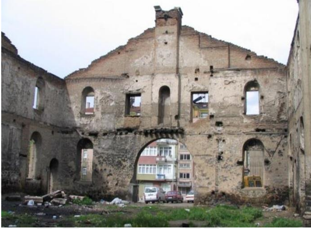
Foto. 151: Merkez ilçesi İzzetpaşa Mahallesi Protestan Kilisesi batı duvarı (Ş. Öztürk Arşivi)
