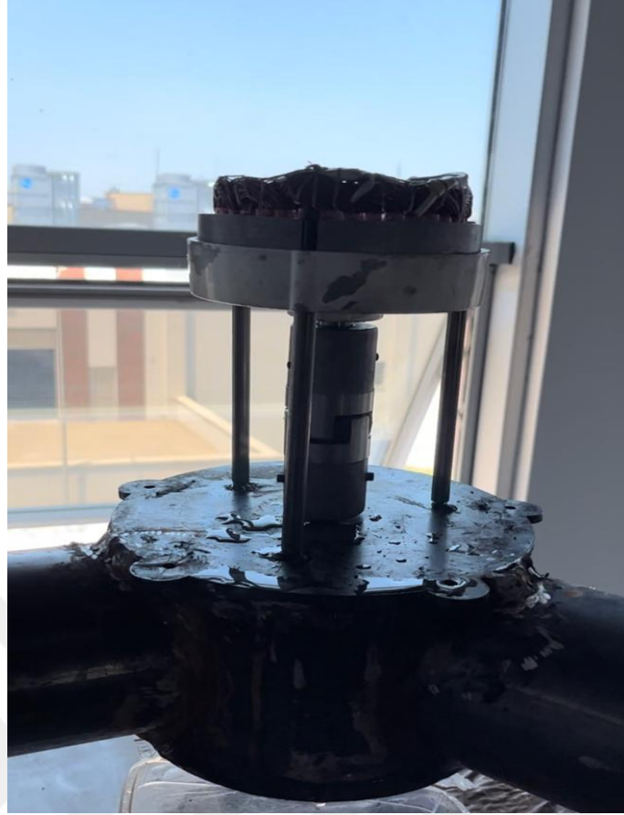
Şekil 4.18 : Türbin miline kaplin ile bağlantısı yapılmış üç fazlı sabit mıknatıslı senkron generatör (3 adet tutucu direk ile sabitlenmiştir).
