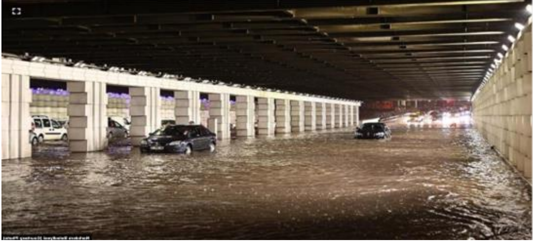
Şekil 1. 2 Yağmur suyunun İzmir Menemen Alt Geçidinde yol açtığı manzara [4].
