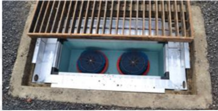
Şekil 1. 6 Yağmursuyu toplama havzası filtreleme sistemi [8].
