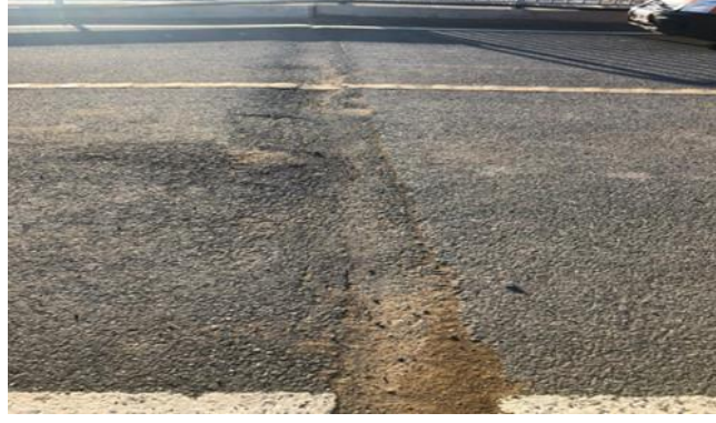
Şekil 4.13 Ek yer çatlakları
