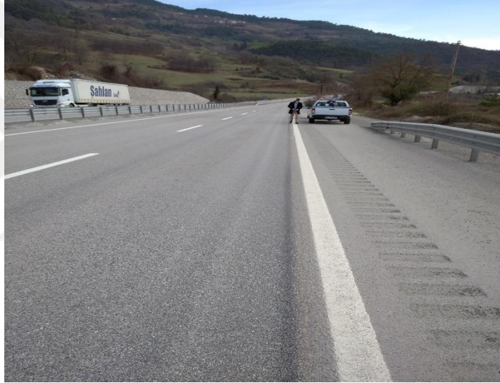
Şekil 6.15 750-01 K.K. numaralı yolda meydana gelen tekerlek izinde oturma
