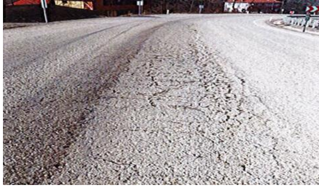
Şekil 4.10 Timsah sırtı çatlak
