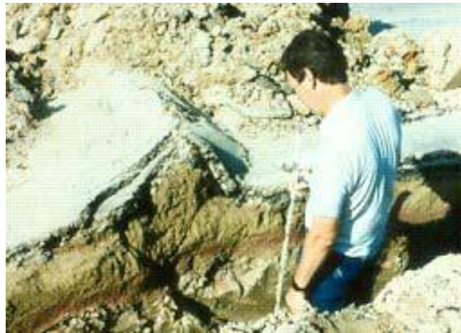
Şekil 2.9: Yolda oluşan kabarma ((Petry, 1992).
