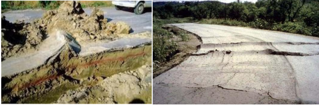
Şekil 2.10: Etrinjit oluşumunun verdiği hasarlar (TDOT, 2000).
