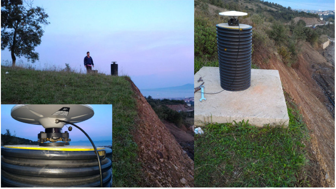
Şekil 3.7 KR17 istasyonunda meydana gelen tahribat
