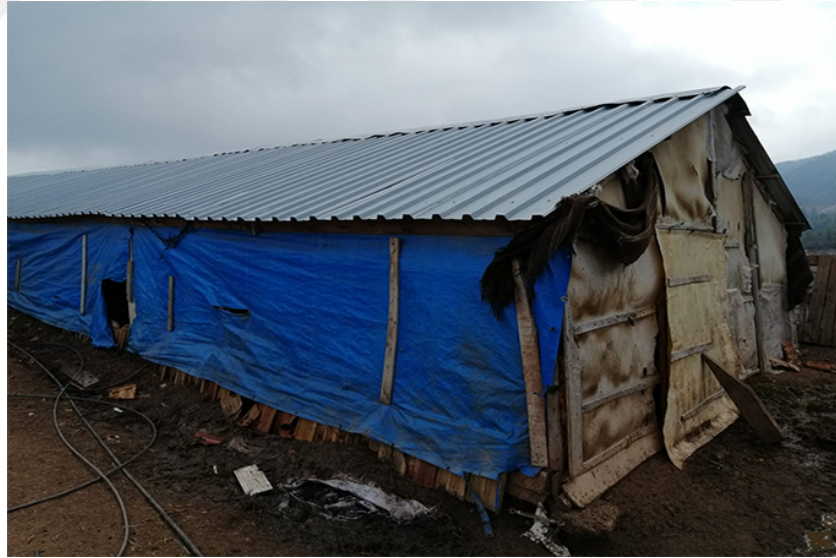
Şekil 4.20. Drenaj koşullarının yeterli olmadığı bir işletme (Konyaaltı)
