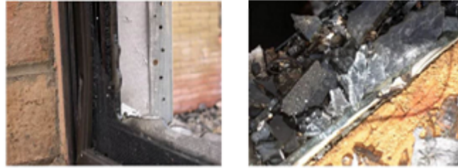
Şekil 2.33 Yangın sonucunda patlayarak etrafa saçılan temperlenmiş cam kaplamalar [107]
