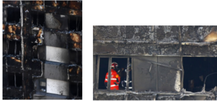
Şekil 2.26 Grenfell Tower yangını sonucu dış cephe kaplamalarının yangın sonrasındaki görünümü [14]
