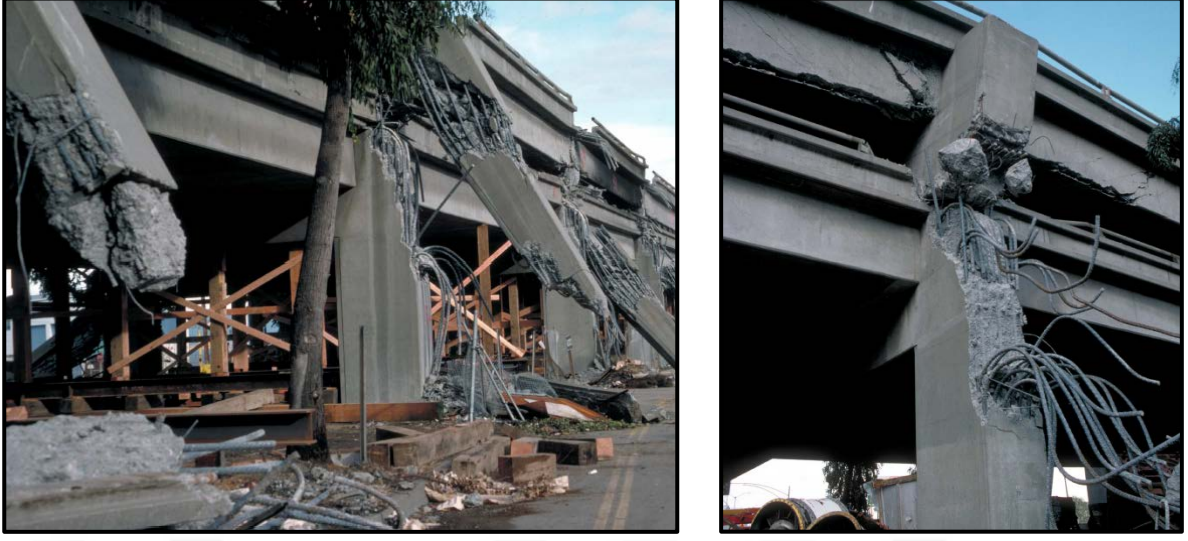
Şekil 1.3: Çöken Cypress Viyadüğü'nün köprü ayaklarından görüntüler (Nakata ve diğ., 1999).
