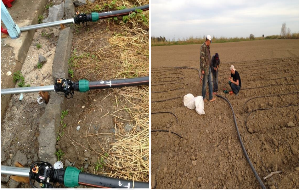
Şekil 3.8. Fertigasyon konularına ait parsel vanaları ve damla sulama sisteminin uygulanması
