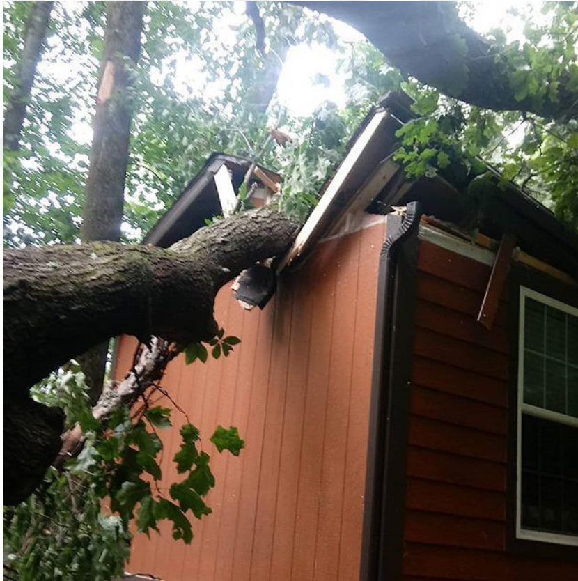
Şekil 1.14. Kesilen dalın ev üzerine düşmesi sonucu maddi hasar
