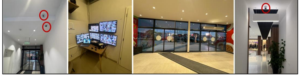
Şekil 5. 38 Ring Mall'da güvenlik, kamera ve alarm sistemleri (Gaş, 2022)
