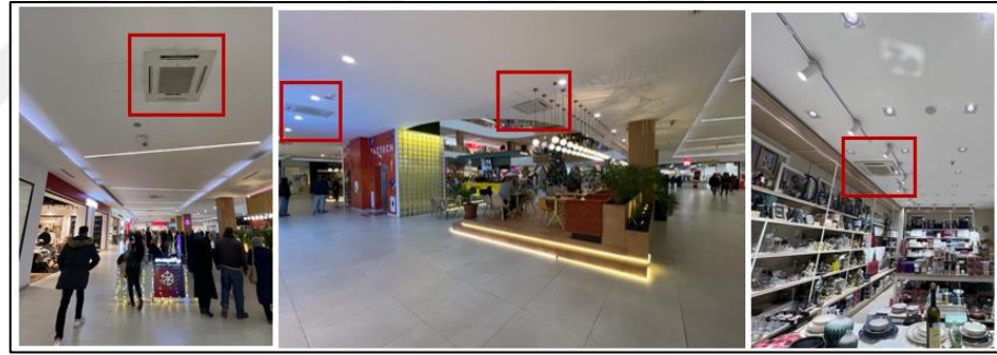
Şekil 5. 20 Galeria Mall'da tavan tipi fankoil üniteleri (Gaş, 2022)
