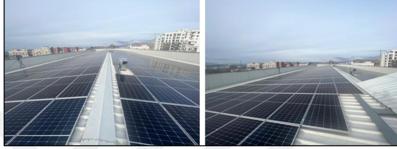
Şekil 5. 12 Albi Mall'ın PV paneller ile kaplı çatı yüzeyi (Gaş, 2022)
