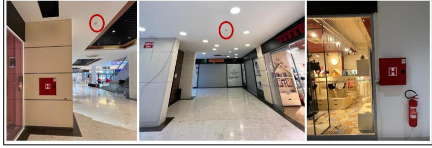
Şekil 5. 48 Albanica Mall’da yangın güvenlik sistemleri (Gaş, 2022)
