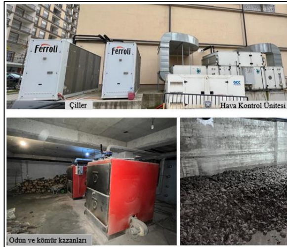
Şekil 5. 45 Albanica Mall’da HVAC Sistemleri (Gaş, 2022)
