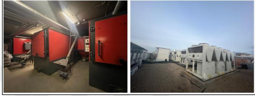
Şekil 5. 10 Albi Mall'da kullanılan pelet kazanları ve su soğutmalı chiller (Gaş, 2022)
