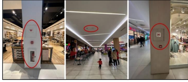
Şekil 5. 23 Galeria Mall'da yangın güvenlik sistemleri (Gaş, 2022)
