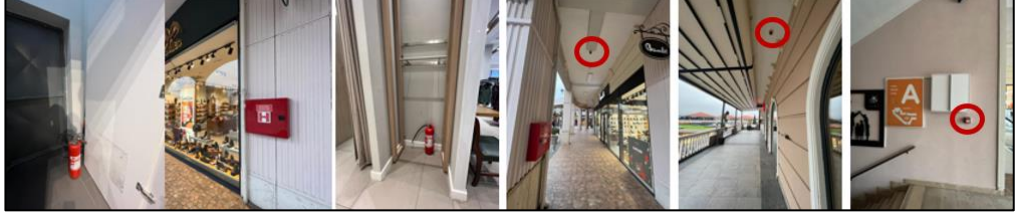
Şekil 5. 31 ABİ Çarşia'da yangın güvenlik sistemleri (Gaş, 2022)
