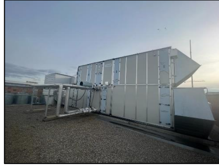
Şekil 5. 11 Albi Mall'da kullanılan hava kontrol ünitesi (Gaş, 2022)
