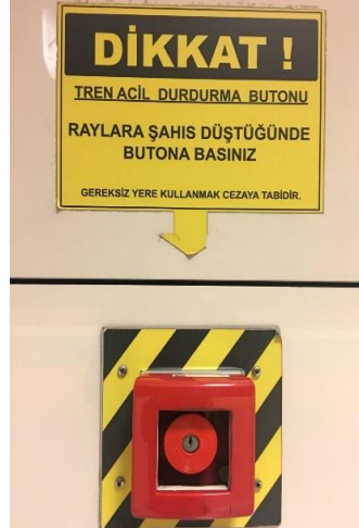
Şekil 3.3 : İstanbul M4 hattı istasyon acil durdurma butonu.
