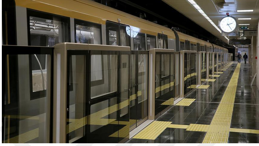
Şekil 3.2 : İstanbul M5 peron ayırıcı kapı sistemleri.
