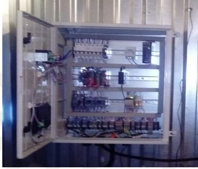
Şekil 3. 7. Revize edilmiş güç panosu
