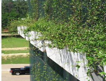
Çok katlı park yapısına monte edilmiş sulama ve drenajlı dikim panelleri, Ridgeland, MS
