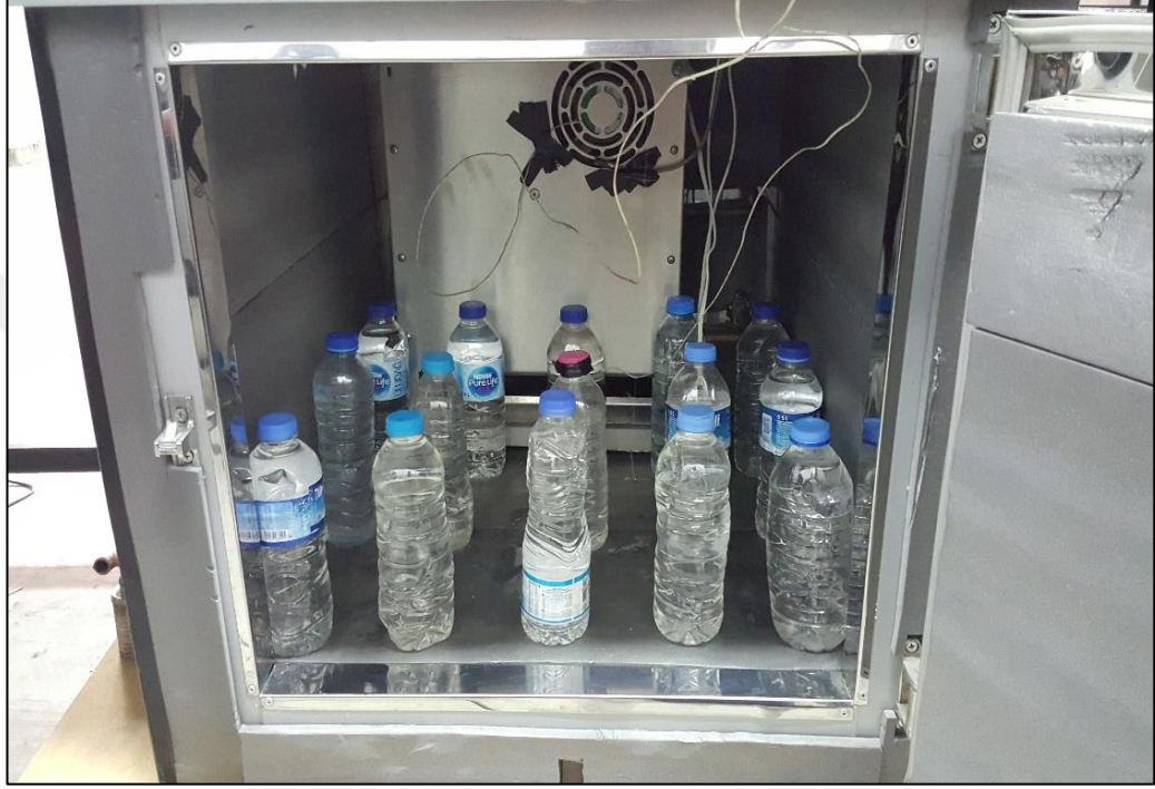
Şekil 4.29. Soğutma dolabı iç mahal görünümü
