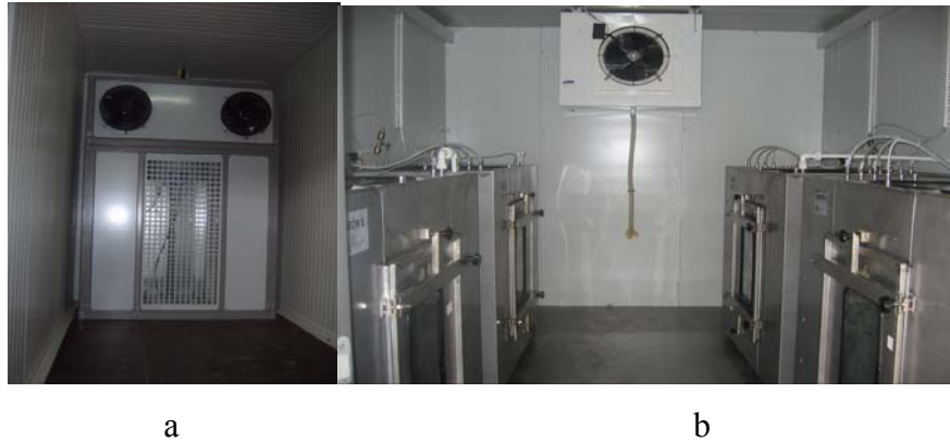
Şekil 3.5. a) Ön soğutma kabini b) Kontrollü atmosfer kabinleri
