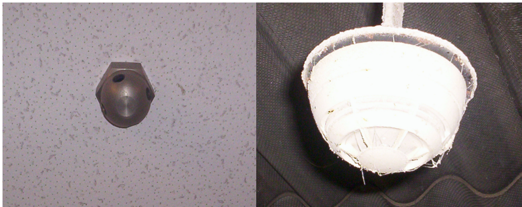
Şekil 6.10. Depolarda kurulan yangın söndürme ve alarm sistemi
