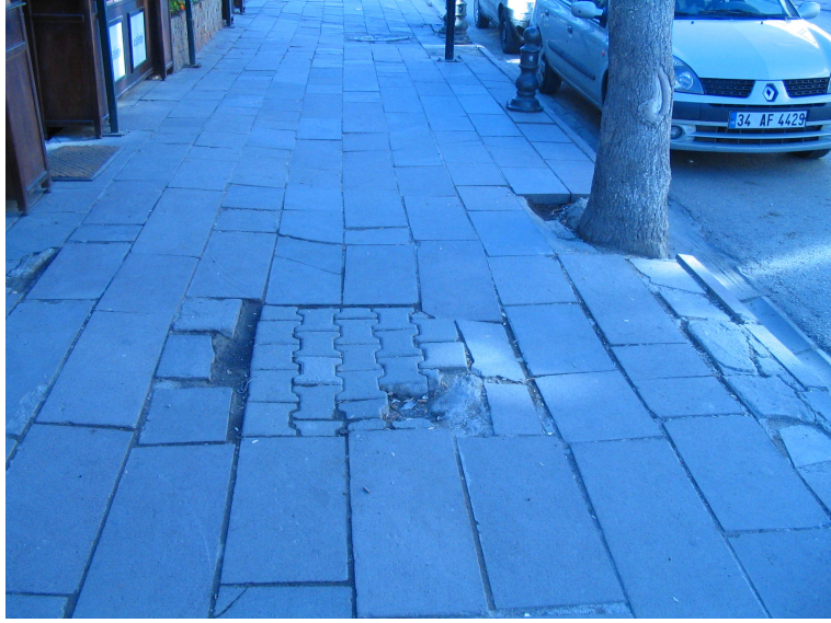
Şekil 4.35 Döşemelerde meydana gelen deformasyonlar için yapılan çalışmalar (orijinal)
