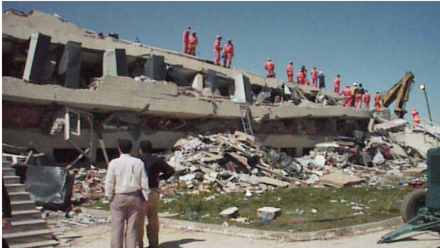
Şekil 2.4 Pansiyon binasının katlarının bir biri üstüne çökmesi
