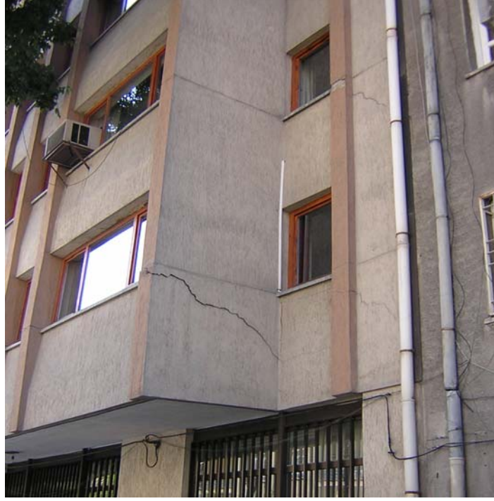
Resim 5.3. konsol çıkmalı betonarme binalardaki çatlaklar
