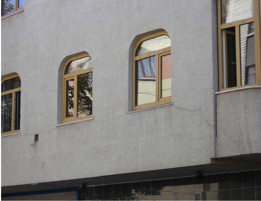
Resim 5.14. konsol çıkmalı betonarme binalardaki çatlaklar
