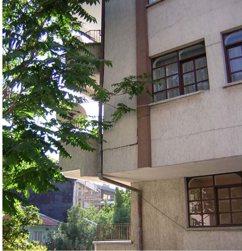
Resim 5.10. konsol çıkmalı betonarme binalardaki çatlaklar
