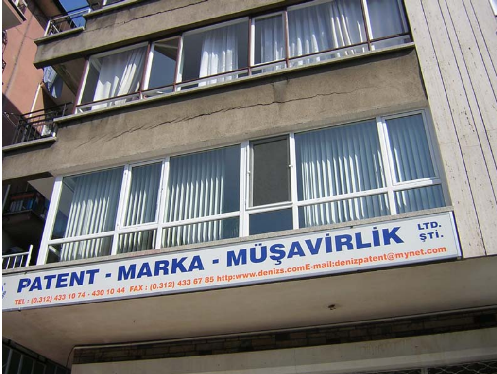
Resim 5.6. konsol çıkmalı betonarme binalardaki çatlaklar
