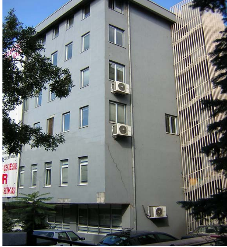
Resim 5.13. konsol çıkmalı betonarme binalardaki çatlaklar
