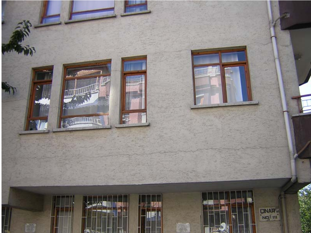
Resim 5.12. konsol çıkmalı betonarme binalardaki çatlaklar
