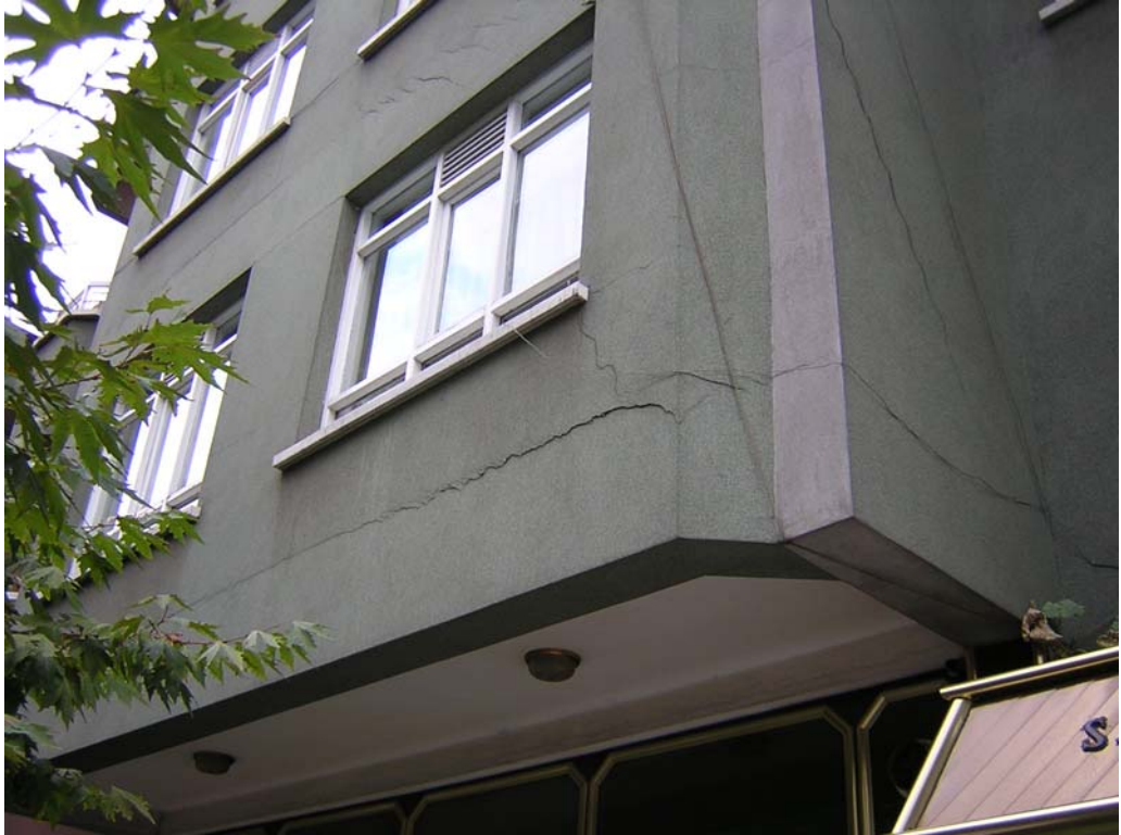
Resim 5.2. konsol çıkmalı betonarme binalardaki çatlaklar
