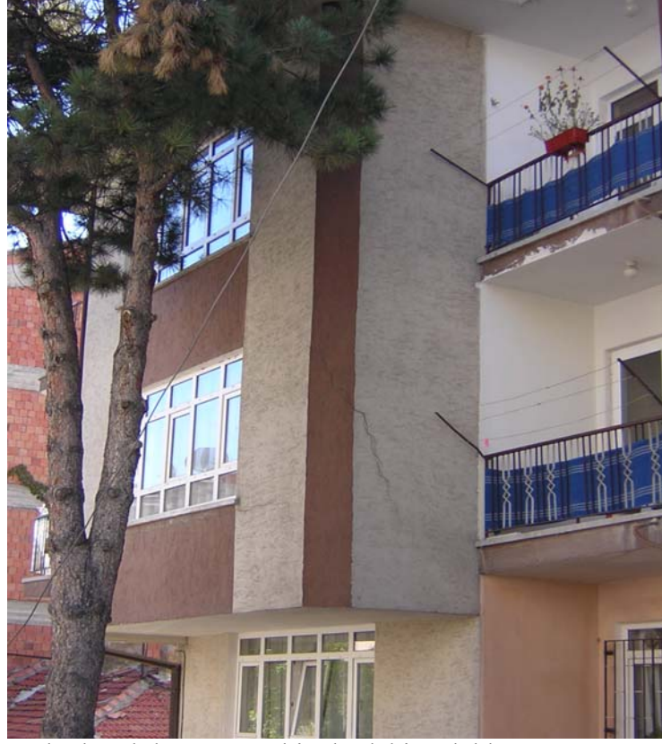
Resim 5.7. konsol ıkmalı betonarme binalardaki atlaklar
