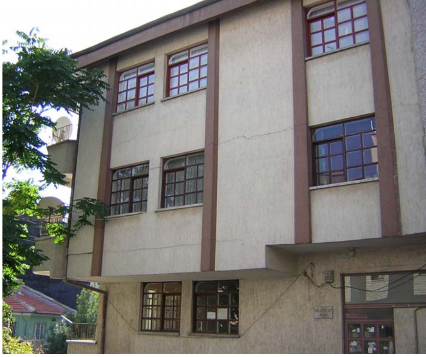
Resim 5.9. konsol çıkmalı betonarme binalardaki çatlaklar
