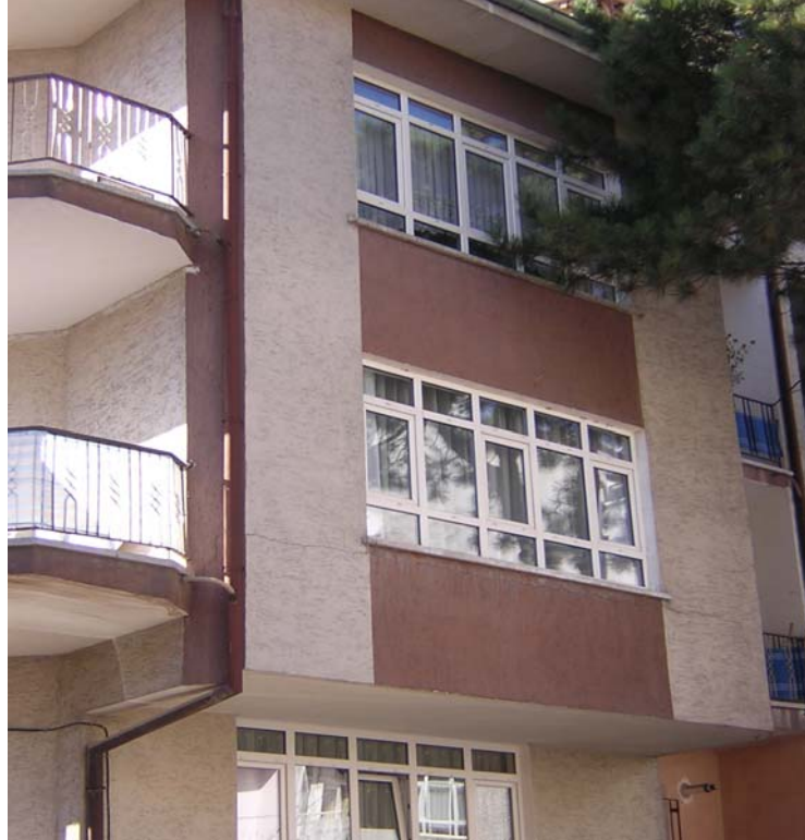
Resim 5.8. konsol ıkmalı betonarme binalardaki atlaklar
