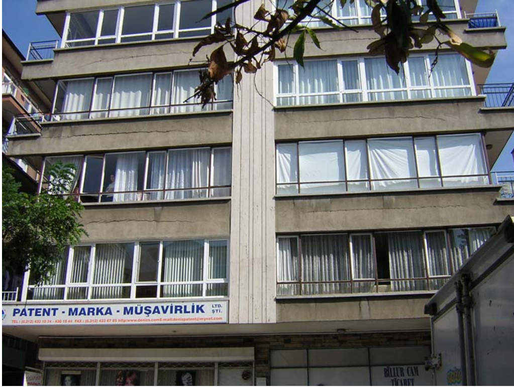
Resim 5.5. konsol çıkmalı betonarme binalardaki çatlaklar
