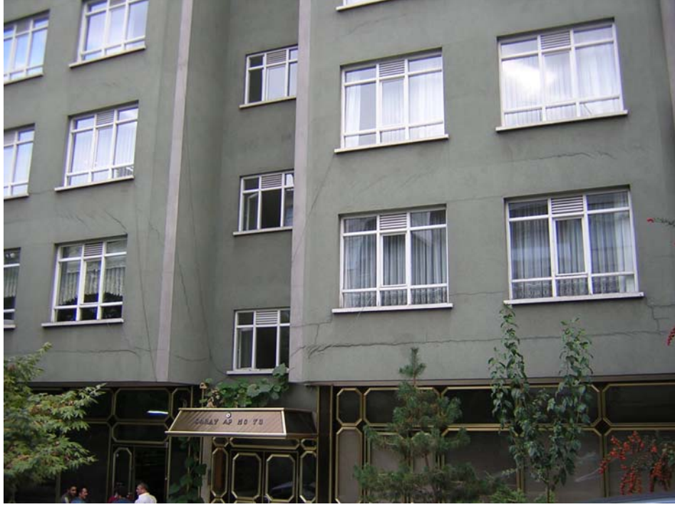
Resim 5.1 konsol çıkmalı betonarme binalardaki çatlaklar
