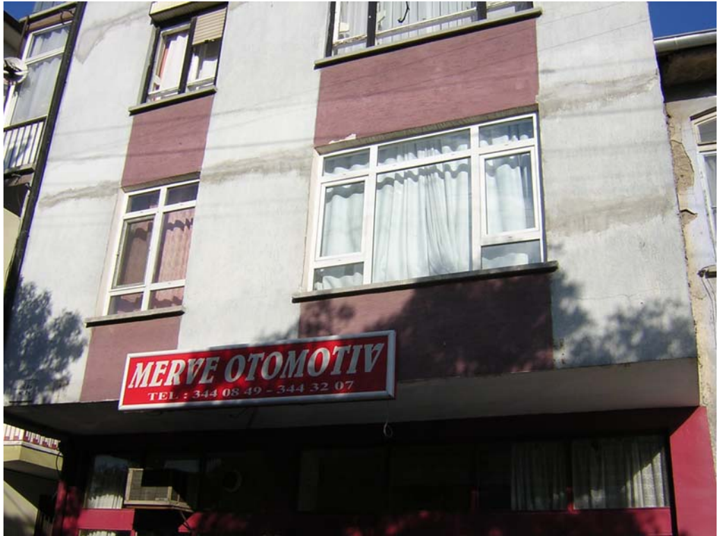
Resim 5.4. konsol çıkmalı betonarme binalardaki çatlaklar
