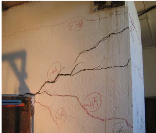
a) Ön duvarın sol üst kısmındaki çatlaklar
