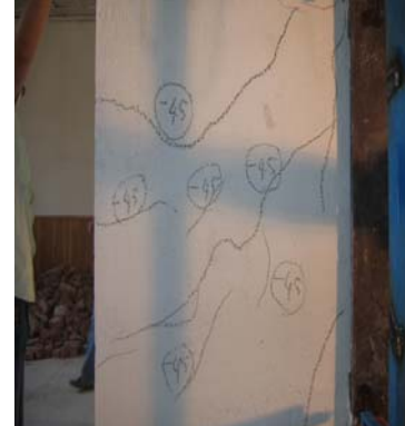
c) Sağ yan duvarın orta bölgesindeki çatlaklar
