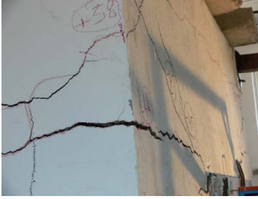
e) Mesnet levhasının sağ yanında çatlak
