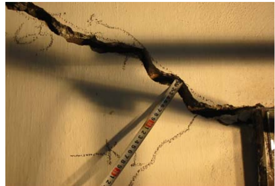
f) Duvarın ön yüzünde ölçülen çatlak
