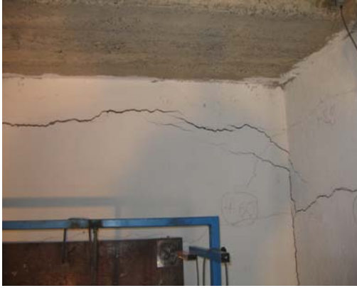
e) Duvarın arka yüzünde sol kısımda oluşan çatlaklar
