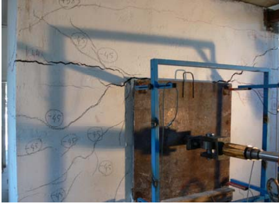
c) Ön duvarla sağ yan duvarın birleşim bölgesindeki çatlaklar
