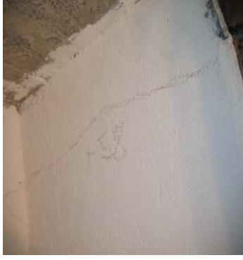
d) Arka duvarın iç tarafında üst bölgedeki çatlaklar
