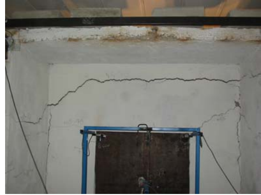
d) Arka duvarın üst ve yan tarafında oluşan çatlaklar
