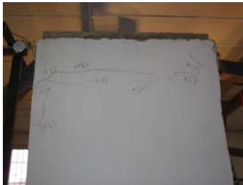
d) Yan duvarın kenar bölgesindeki çatlaklar
