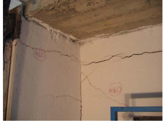
d) Arka duvarla sağ yan duvarın birleşim bölgesindeki çatlaklar
