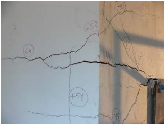
a) Ön duvarın sol üst kısmındaki çatlaklar
