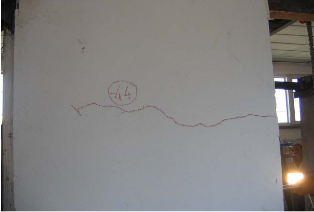
Şekil 5.22 2 nolu deney numunesinde 5. çevrimde oluşan çatlaklar
