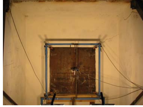
d) Arka duvarın orta kısmındaki çatlaklar
