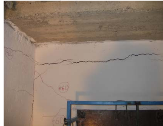
b) Arka duvarla sağ yan duvarın birleşim bölgesindeki çatlaklar
