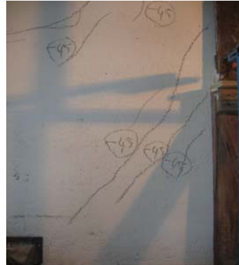
b) Ön duvarın sol tarafındaki çatlaklar
