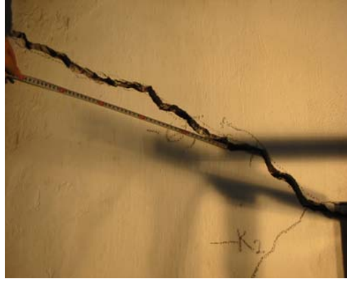
c) Sağ yan duvarda ölçülen çatlak
