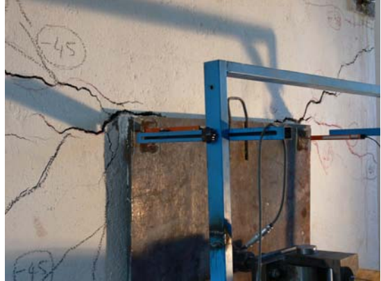
f) Sağ yan duvarda oluşan çatlaklar
