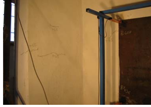
b) Arka duvarla sağ yan duvarın birleşim bölgesindeki çatlaklar
