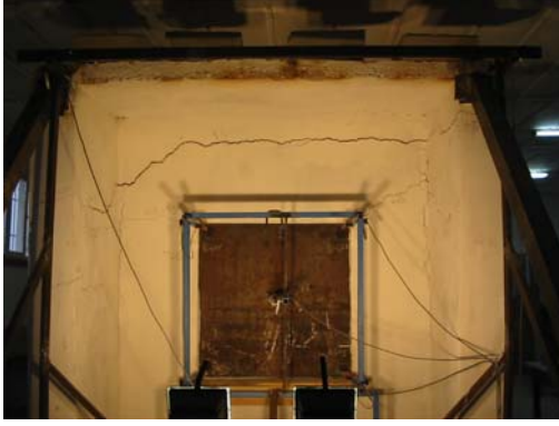
a) Arka duvarın üst bölgesinde oluşan çatlaklar
