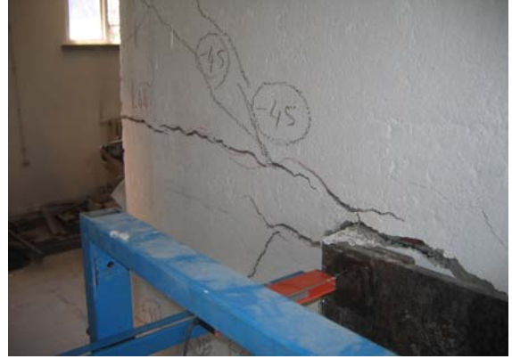
d) Ön duvarla sağ yan duvar arasında oluşan çatlaklar
