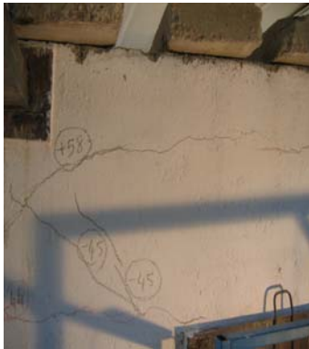
a) Ön duvarın sağ tarafındaki çatlaklar
