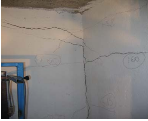
c) Arka duvarla sol yan duvarın birleşim bölgesindeki çatlaklar
