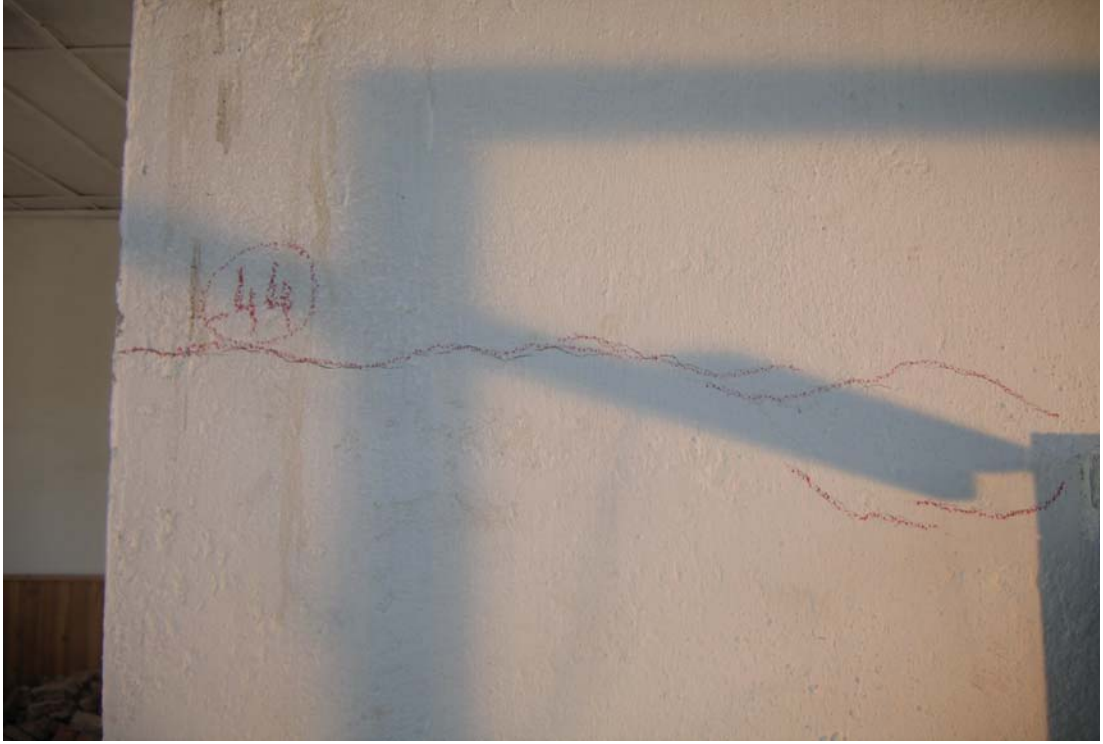
Şekil 5.21 2 nolu deney yan duvarda sol arka mesnetin altında oluşan ilk çatlak
