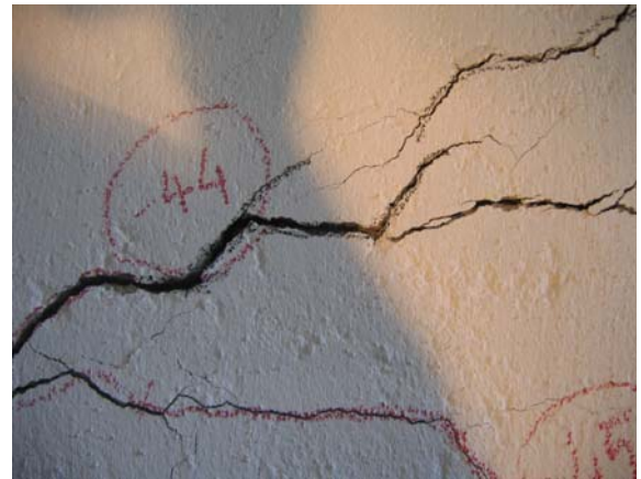
b) Yükleme levhasının sol üst kısmında ilerleyen ve genişleyen çatlaklar
