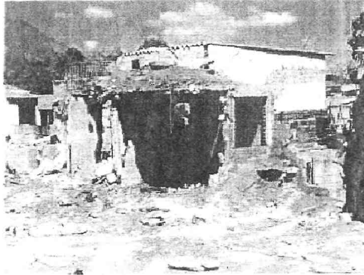
Şekil 1.21 Las Colinas'da deprem sırasında yıkılmış toprak damlı yığma yapı
