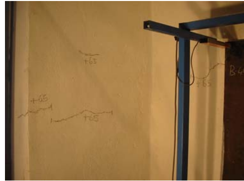
f) Sağ yan duvarda oluşan çatlaklar
