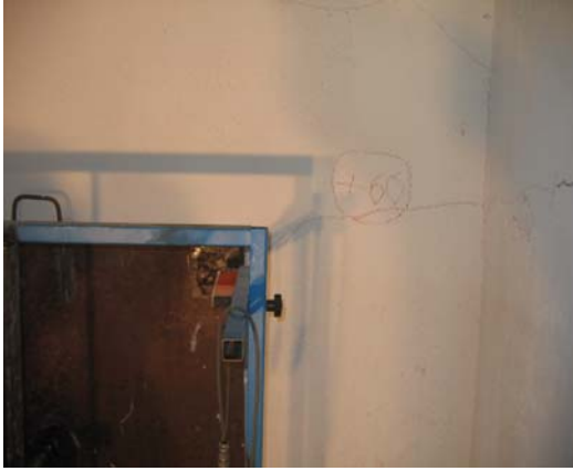
e) Mesnet levhasının sol yanında çatlak
