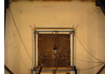
f) Duvarın arka bölgesindeki çatlaklar
