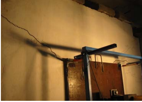
a) Arka duvarın sağ üst kısmındaki çatlaklar
