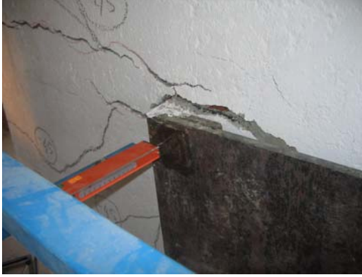
c) Ön duvarla sağ yan duvarın birleşim bölgesindeki çatlaklar
