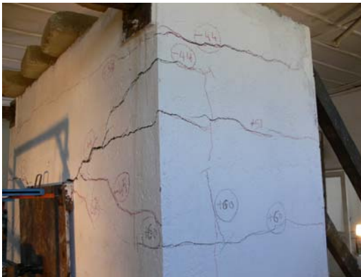
a) Ön duvarın sol üst kısmındaki çatlaklar
