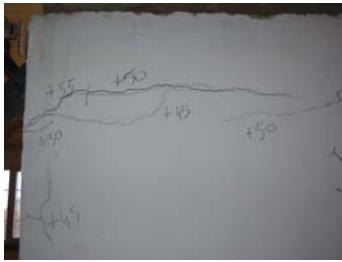
a) Yan duvarın sol tarafındaki çatlaklar
