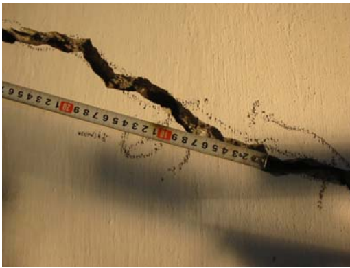
e) Duvarın ön yüzünde ölçülen çatlak
