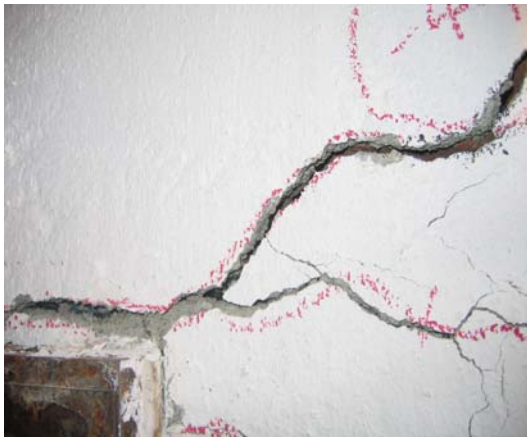
a) Yükleme levhasının sol üst kısmında ilerleyen ve genişleyen çatlaklar
