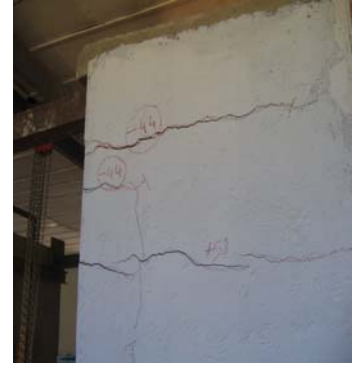
f) Duvarın ön tarafıyla sağ tarafının birleşim bölgesinde oluşan çatlaklar
