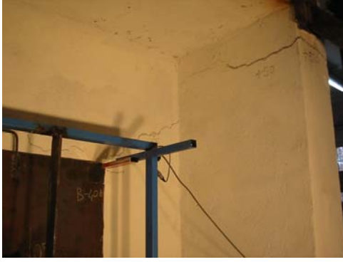
c) Arka duvarla sol yan duvarın birleşim bölgesindeki çatlaklar
