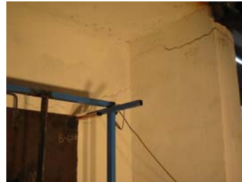
e) Duvarın arka üst bölgesindeki çatlaklar
