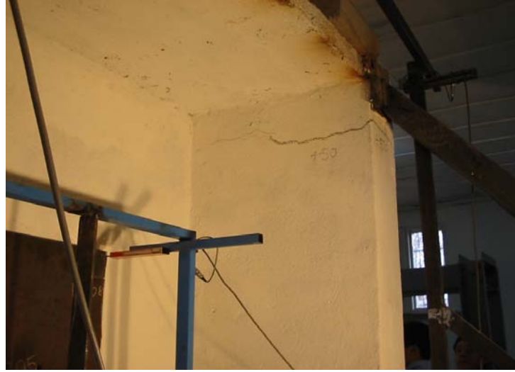
Şekil 5.6 1 nolu deney sol arka mesnette oluşan çatlak (Yük; 50 kN, Dep. 5,4mm)
