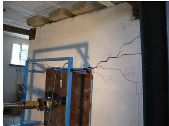
b) Ön duvarla sol yan duvarın birleşim bölgesindeki çatlaklar
