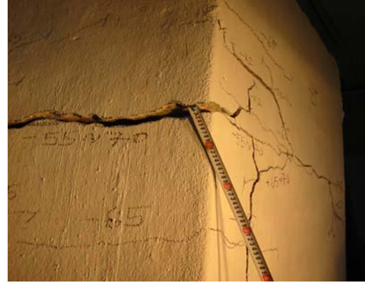
d) Duvarın ön yüzüyle sol yan duvar arasında ölçülen çatlak
