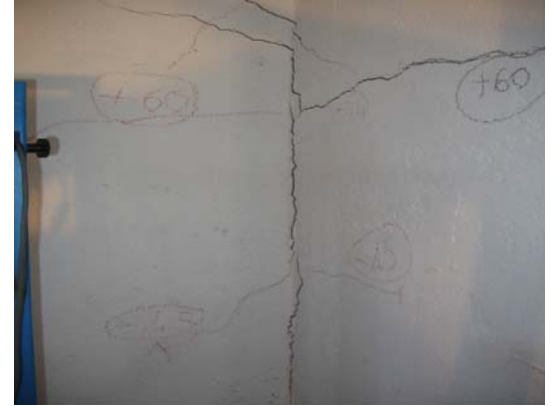
f) Arka duvarla sol yan duvarın birleşim bölgesindeki çatlaklar
