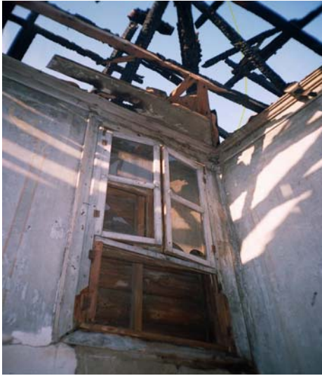
Resim B.7. Birinci Katta Hasar Gören 1.Oda
