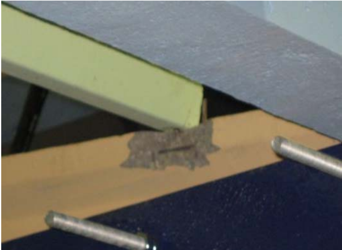
Şekil 4.80 Makas aşık birleşim bölgesinde hasar
