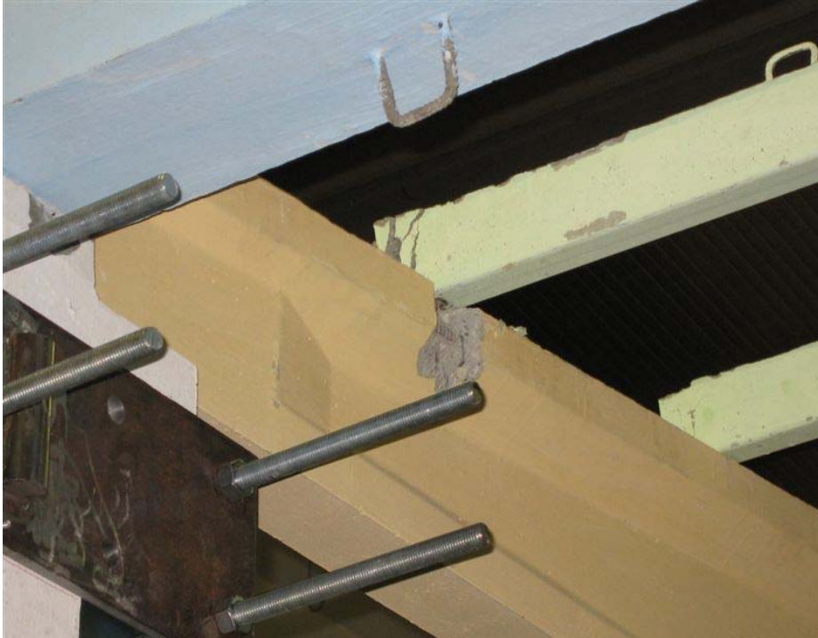
Şekil 4.84 A aksından yükleme deneyinde aşığın ve makas birleşim bölgesindeki hasarları
