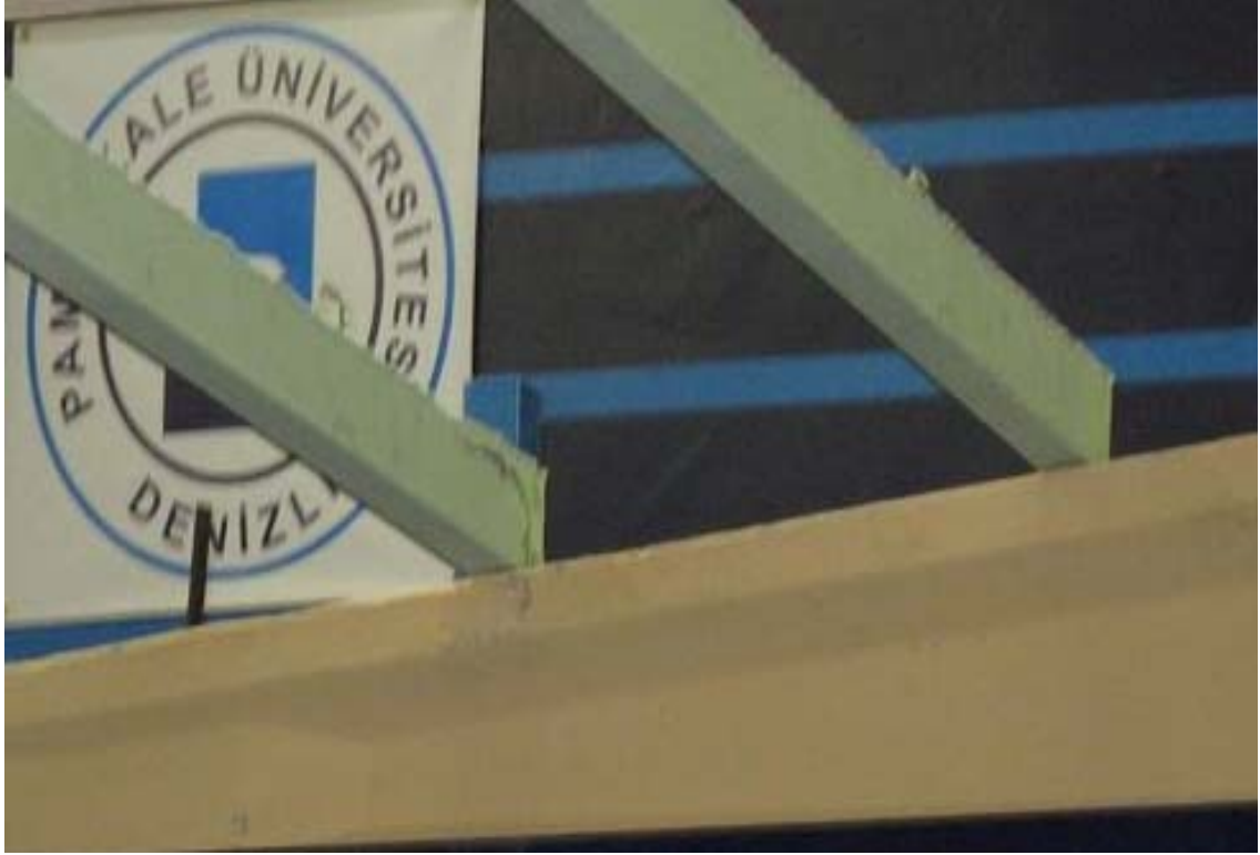
Şekil 4.81 Aşık ucunda oluşan hasar
