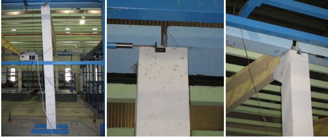
Őekil 4.65 2 aksının yer deęiřtirmesi ve O1 ve O2 olukları hasarları
