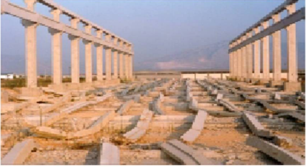
Şekil 2.4 1998 Ceyhan depreminde çatı bölgesi göçmüş PBA sanayi yapısı
