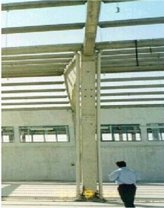
Şekil 2.3 Marmara depreminde PBA makas yanal ötelenmesi
