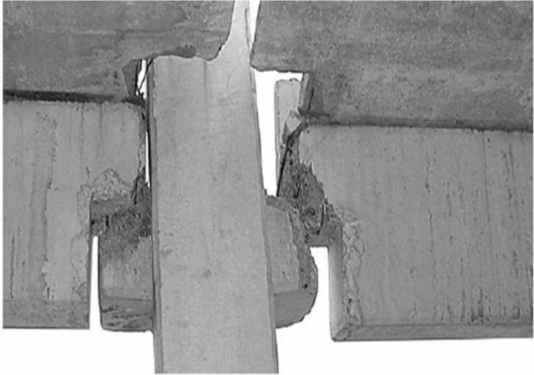
Şekil 2.6 Kolon kiriş birleşim bölgesinde hasar
