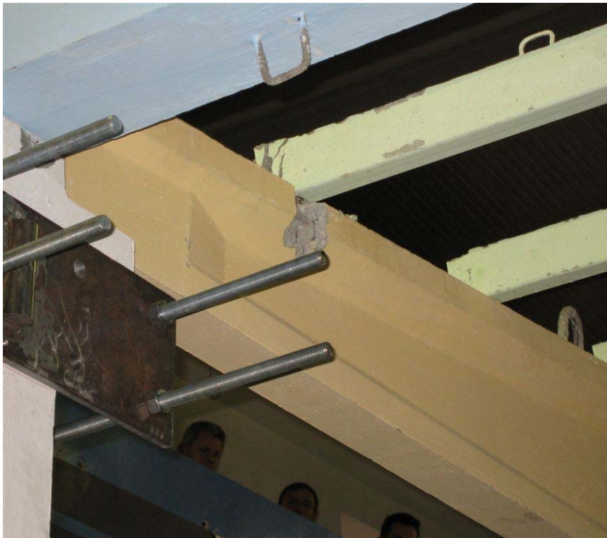
Şekil 4.73 Makas ve ařıkta oluřan hasarlar
