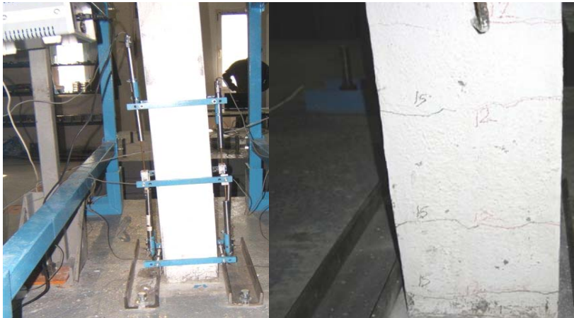
Şekil 2.16 Kolon alt bölgesindeki eğrilik ve hasarlar
