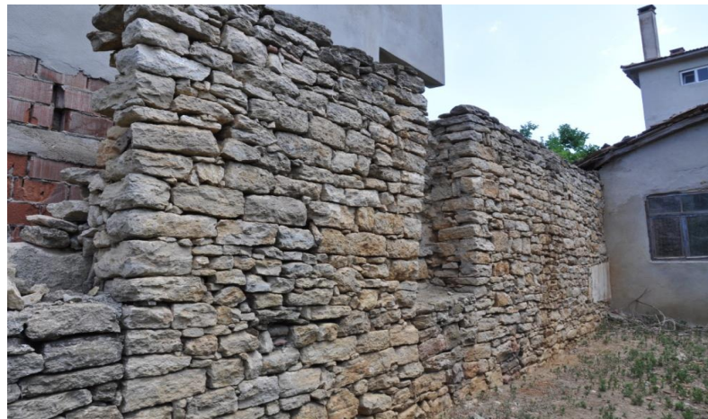
Şekil 4.42. Tekirdağ Dedecik köyü yıkılan yel değirmeninin taşlarının kullanıldığı konutun bir bölümü, 29.06.2025 tarihinde Sıdika Çakıl tarafından yerinde çekimi.
