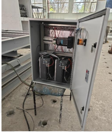
Şekil 6.26. PLC Kontrollü Otomasyon Sistemi
