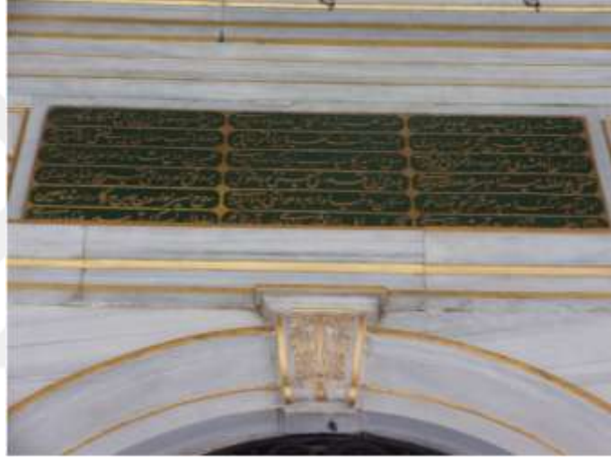
Şekil 4. 62. Emir Sultan Türbesi güney cephede yer alan Sultan Abdülaziz Dönemine ait olan onarım kitabesi (Gök arşivi, 2022)
