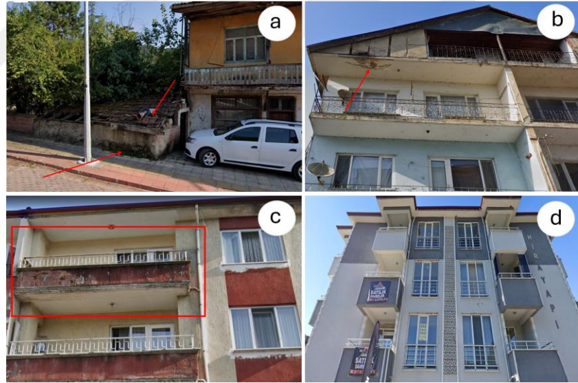
Fotoğraf 7. Bina koşul durumlarına örnek yapılar a) yaygın çatlak ve deformasyon b) genelleştirilmiş çatlama ve deformasyon c) yaygın çatlak ve deformasyon d) hasar çatlama olmayan yapı
