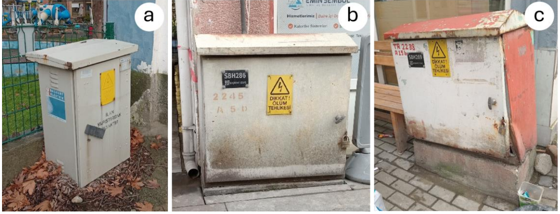
Fotoğraf 23. Trafo yıpranma durumuna göre örnek yapılar a) yıpranma yok veya hafif yıpranmış b) Ağır yıpranmış c) Kısmen yıpranmış, ancak işlevsel
