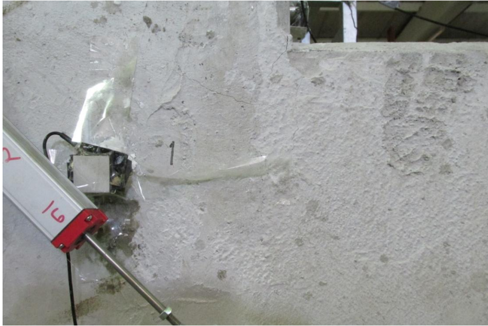
Şekil 5.2.4. Ön yüz kesme ve dik çatlaklar
