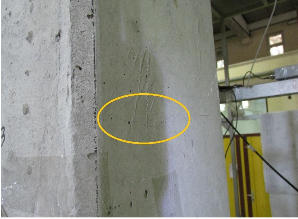
Şekil 5.2.3. Gözlemlenen ilk eğilme çatlakı
