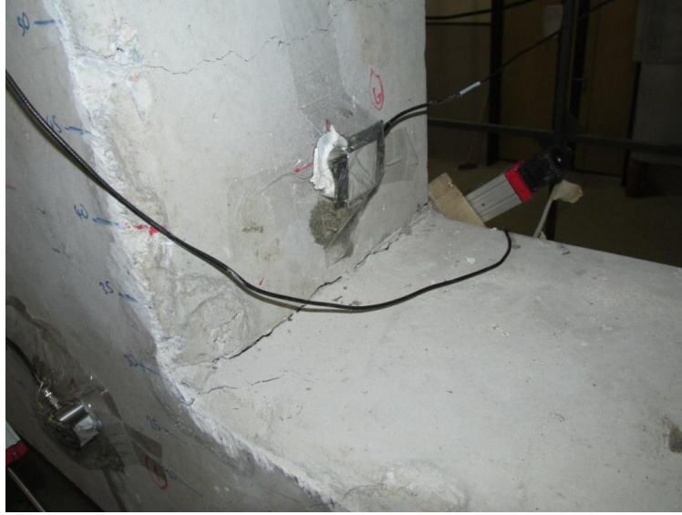
Şekil 5.7.3. Kolon-kiriş birleşim bölgesinde yatay çatlak
