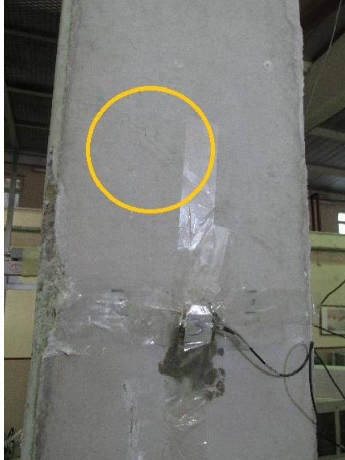
Şekil. 5.3.3. 50 cm yukarıda oluşan kesme çatlağı
