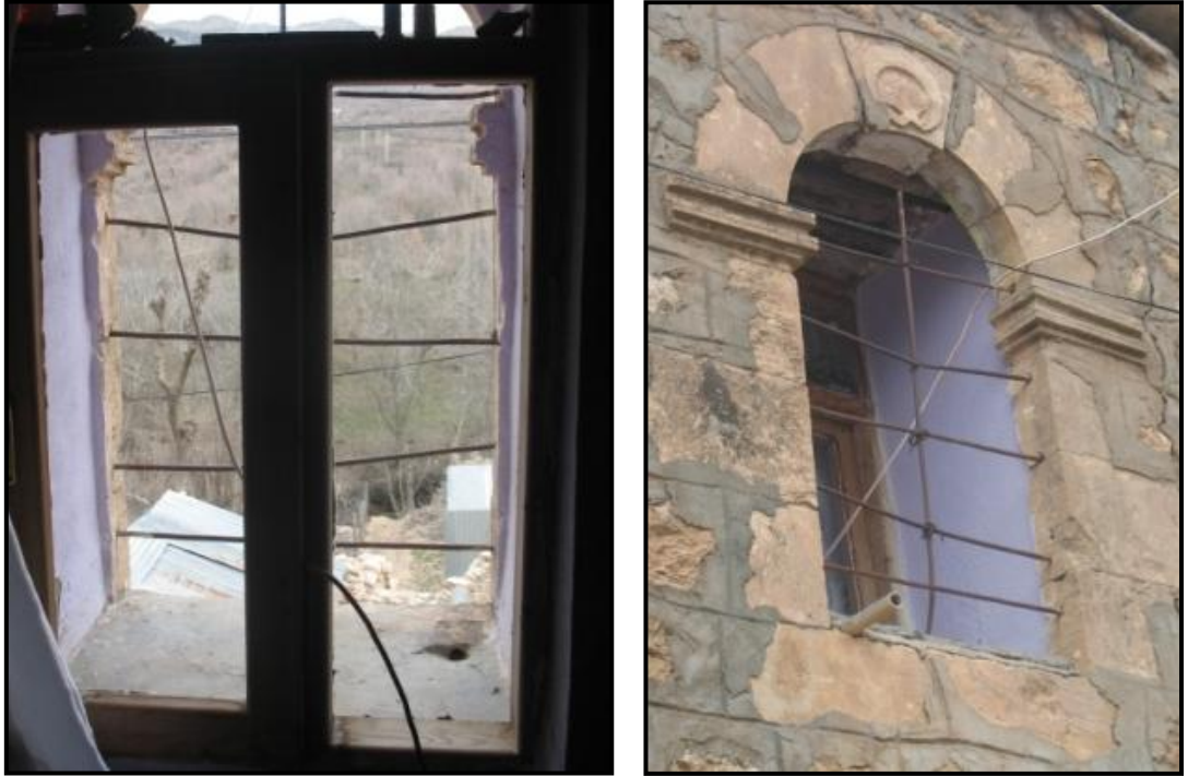
Şekil.3.94 Pencerelerde yağmur suyu tahliyesi (Diyarbakır, 2012)
