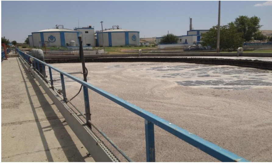
Şekil 4.15. Havalandırma havuzunda yüzen köpük problemi
