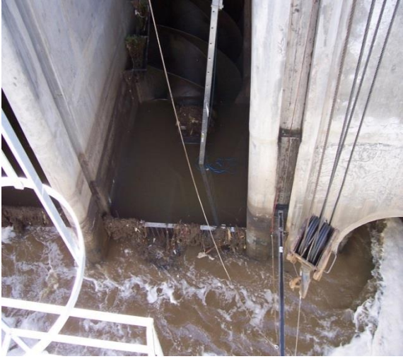
Şekil 4.3. Giriş pompa istasyonunda yaşanan sıkıntılar
