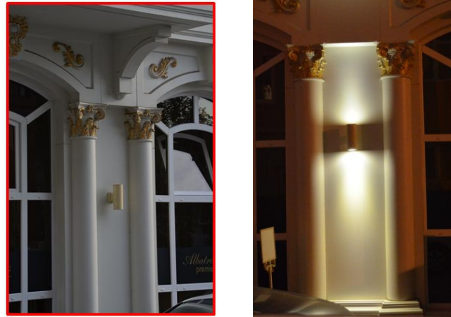
Şekil 6.5 Albatros Hotel giriş katı kolon aydınlatması
