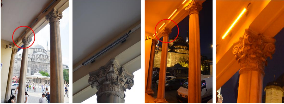
Şekil 6.61 Kolonlar arkasındaki aydınlatma aygıtlarının konumu
