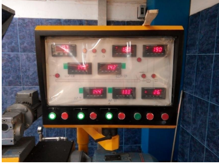
Şekil 3.7. Ekstruder kontrol paneli
