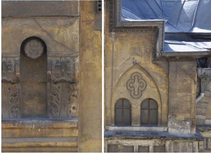
Şekil 4.206 : Malta taşı konsol üzerinde ve kaplama taşlarında kabuk oluşumu.
