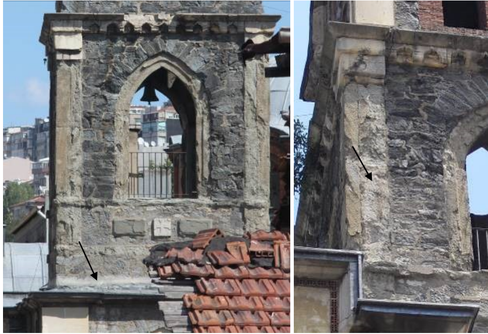
Şekil 4.229 : +12.94 kotundaki saçak silmesi üzerinde yükselen kulelerin odtaşı köşe taşlarında kavlanma, yüzey kaybı ve parça kopması.
