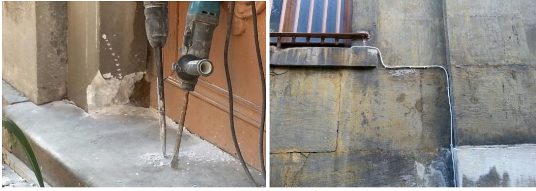
Şekil 4.218 : Klima takılması sırasında yapıya verilen zarar.
