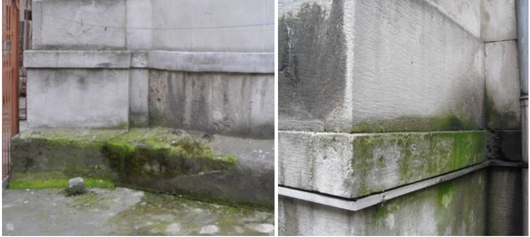
Şekil 4.205 : Zeminden yükselen suyun cephelerde oluşturduğu hasar.
