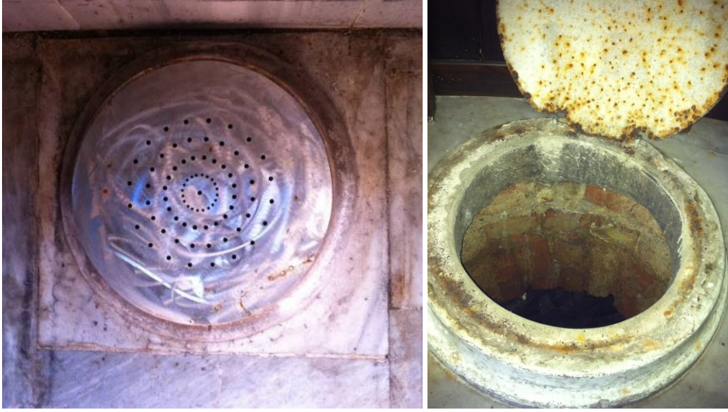
Şekil 4.259 : Zemin kat döşemesinde havalandırma amaçlı bodruma açılan delik.
