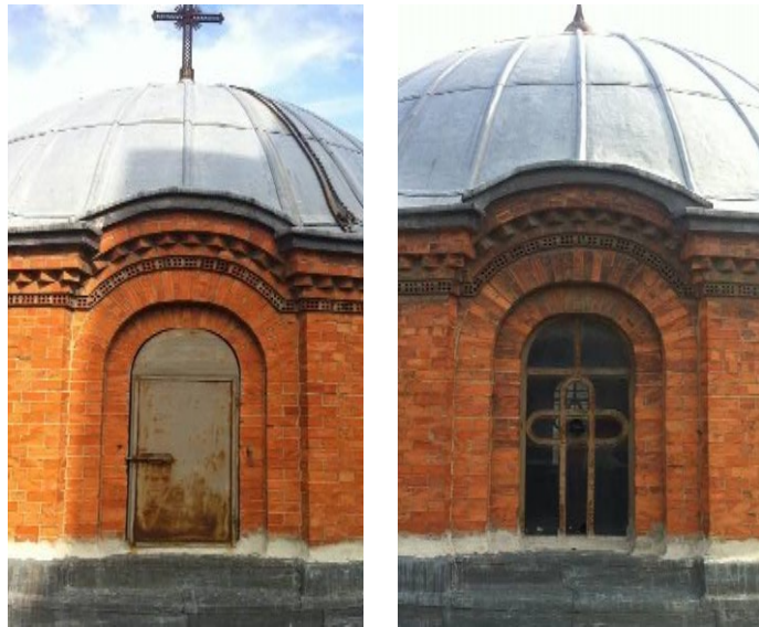
Şekil 4.242 : Kubbe kasnağındaki pencere doğramalarında ve kapıda korozyon.
