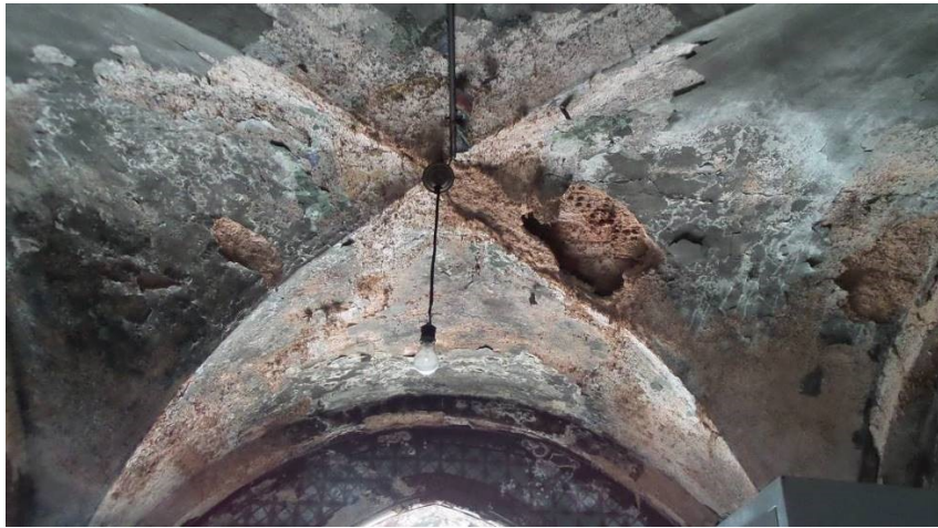
Şekil 4.208 : Sıva üstü kalemişi bezemeli tonozda sıva dökülmesi ve çiçeklenme.
