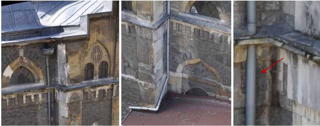
Şekil 4.240 : Cephenin özgün ve sonradan eklenen çinko yağmur iniş boruları.
