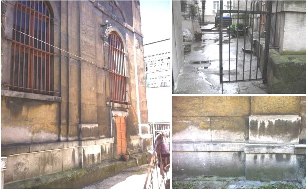
Şekil 4.204 : Zeminden ykselen nemin cephelerde oluşturduğu hasar.
