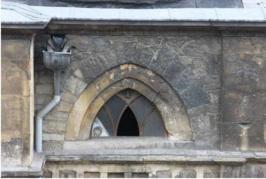
Şekil 4.207 : Grovak duvar yüzeyinde hava kirliliğine bağlı kabuk oluşumu.
