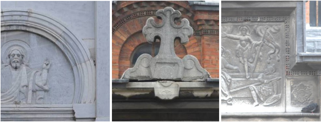
Şekil 4.212 : Mermer kemer aynası ve bezeme ögesinde görülen şekersî aşınma ve mermer ikonada kabuk oluşumu.
