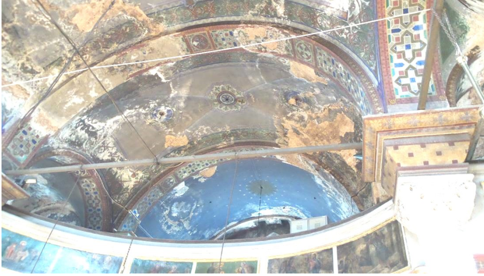
Şekil 4.243 : Kalem işi bezeli tonozlarda oluşan hasarlar.
