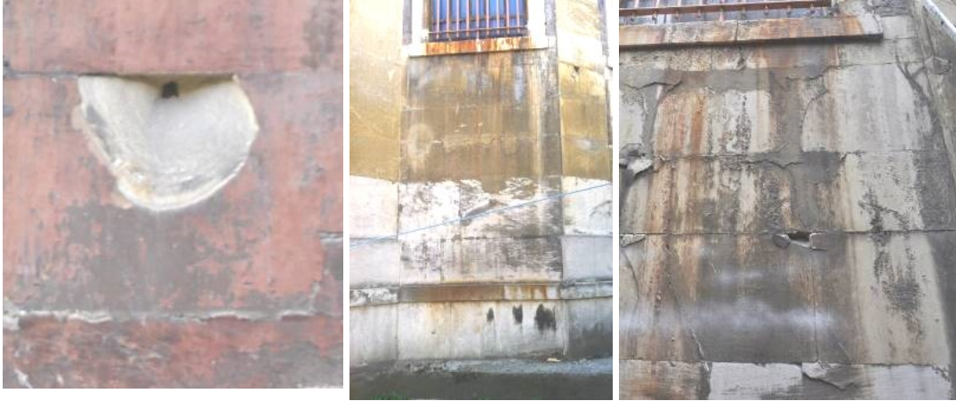
Şekil 4.211 : Biyomikritik kireçtaşı pilastırlarda metal korozyonuna bağlı parça kopması ve cephede pas lekeleri.
