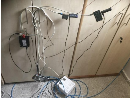
Resim 4.1. Veri toplama sistemi bina içi yerleşimi
