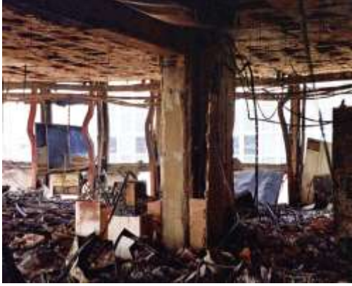
Resim 2.8. Betonarme strüktürde yangının etkisi [44]
